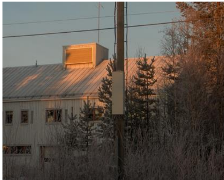
Kuva 16. Tievalaistuksen pylväs keskus.
