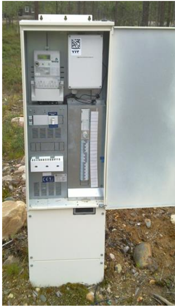
Kuva 17. Pyramide –ohjausjärjestelmä keskuksessa
