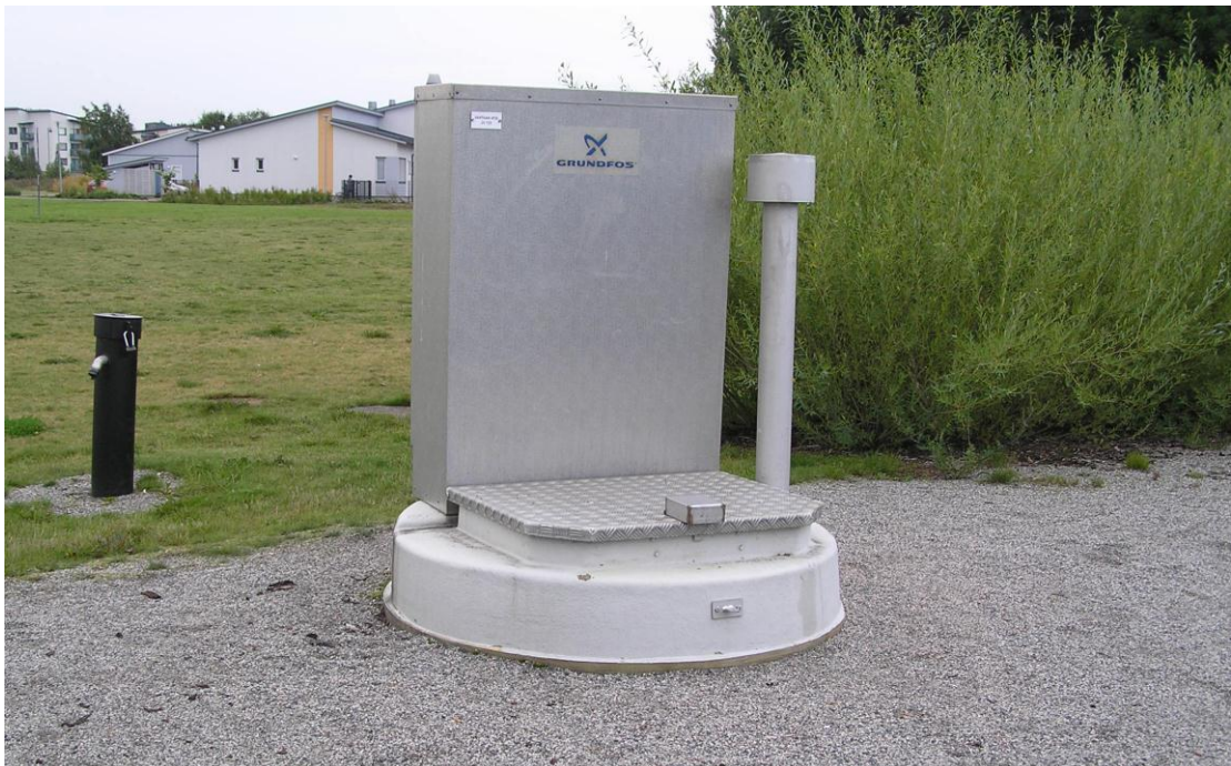
Kuva 1. Jätevedenpumppaamo maan päältä katsottuna
