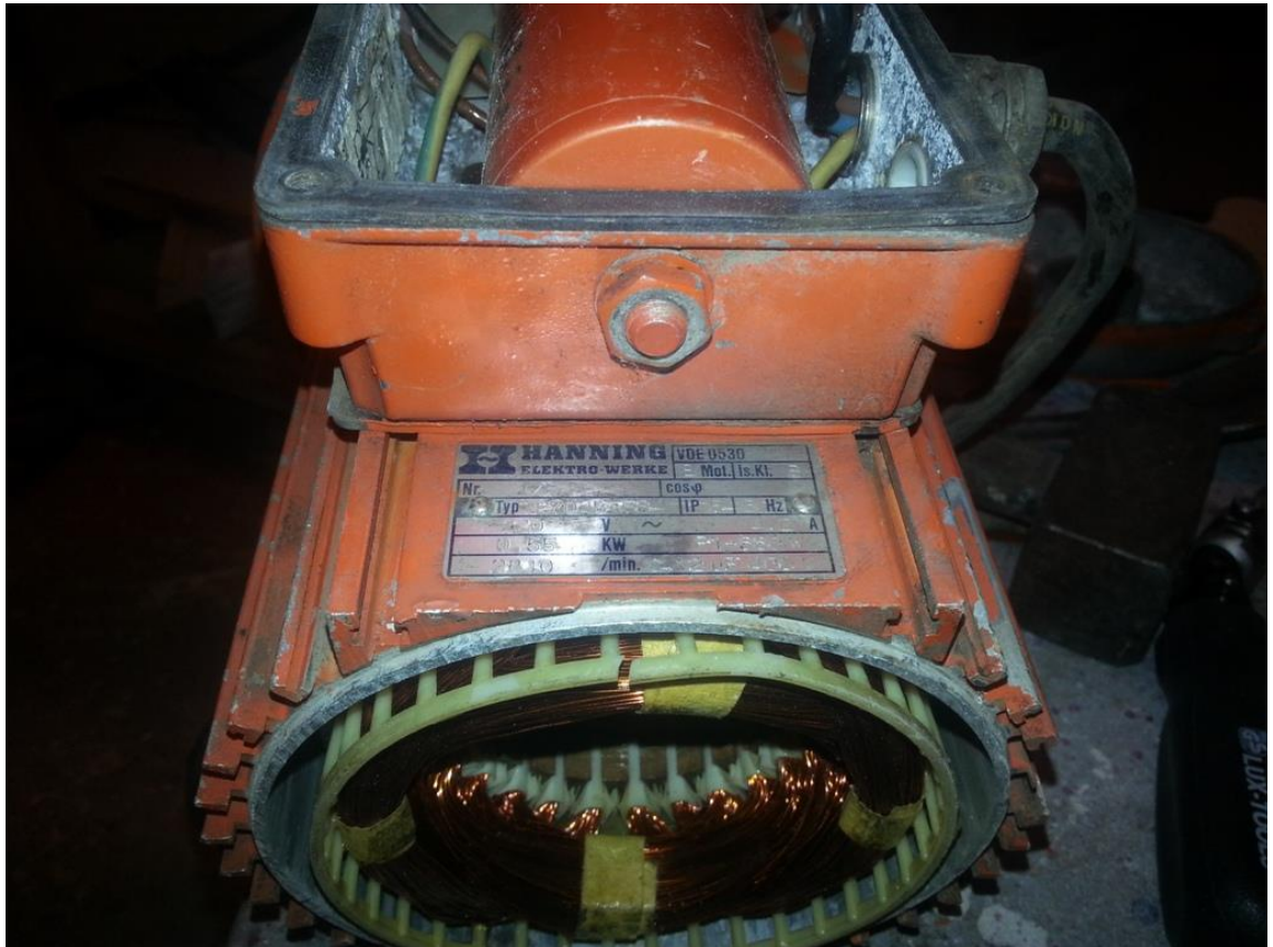
KUVA 11. Käytettävä sähkömoottori purettuna
