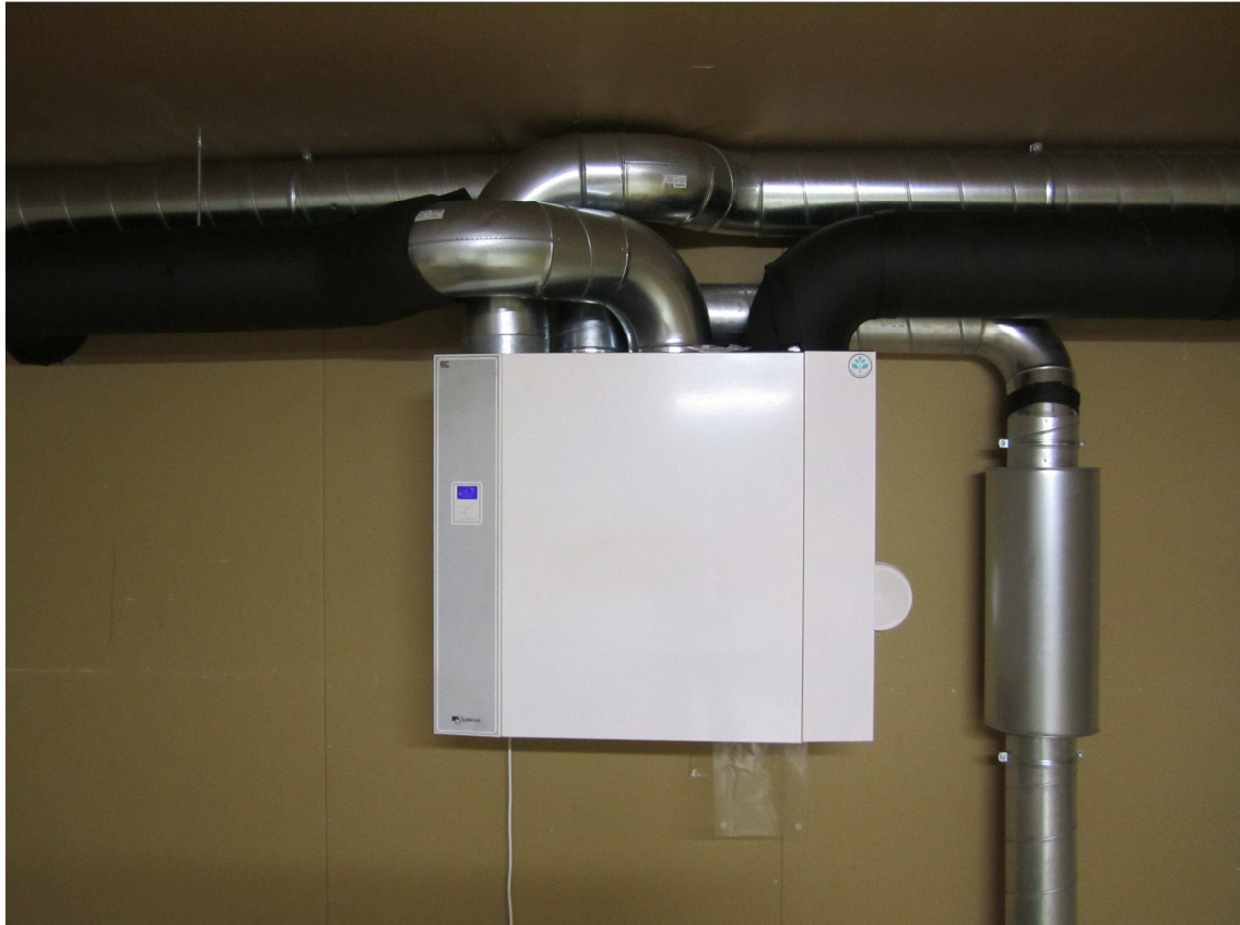
Figur 14. Ventilationsmaskinen och ventilationsrören på övre våningen. (Dennis Hindersson)
