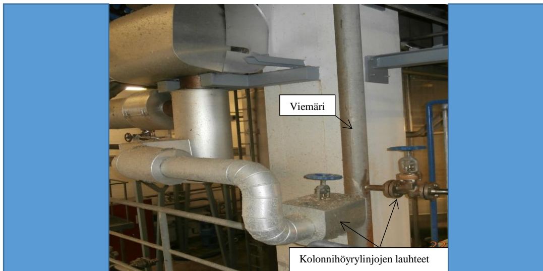
Kuva 12 Strippauskolonnien höyrylinjojen vesitykset ohjautuvat viemäriin.
