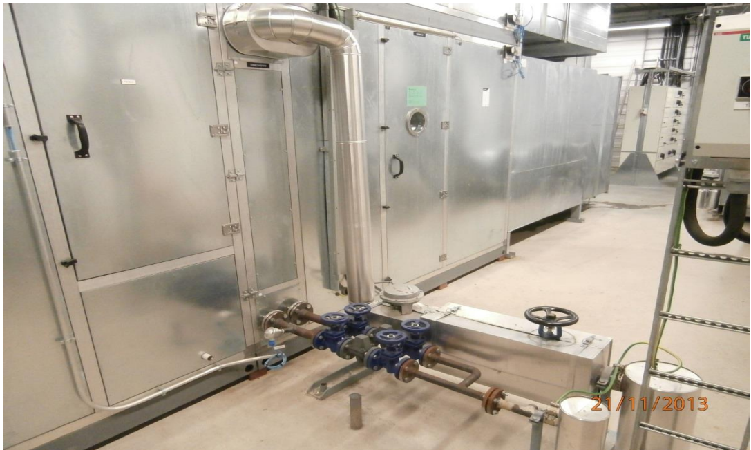
Kuva 24 Tuotantotilan ilmastoinnin höyrypatterin alkutilanne ennen muutosta
