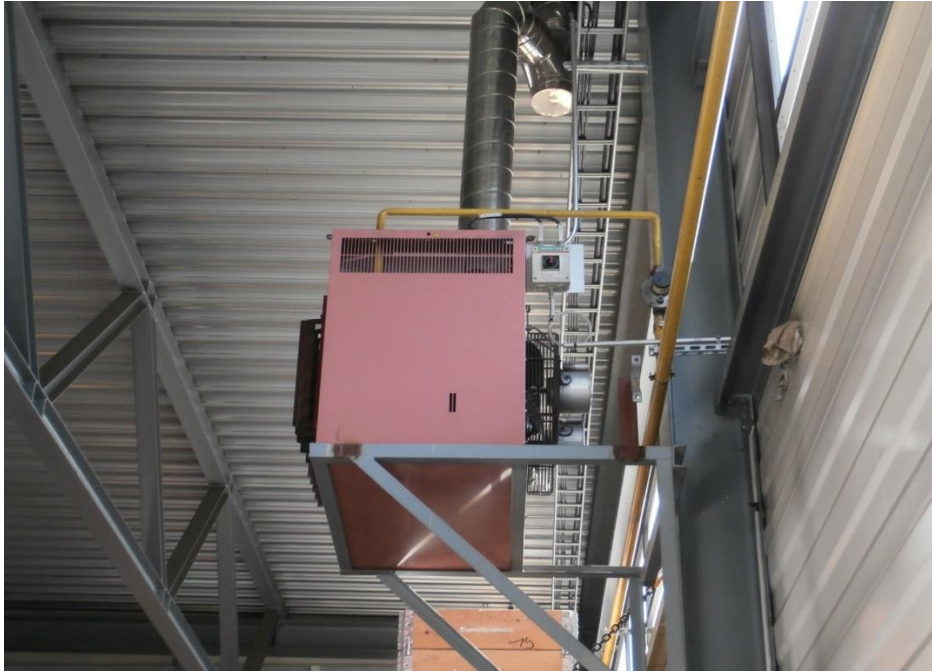
Kuva 17 Varaston kaasutoiminen ilmalämmitin
