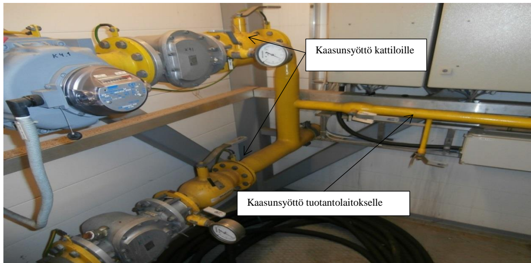
Kuva 10 Kaasun jako kattilarakennuksessa
