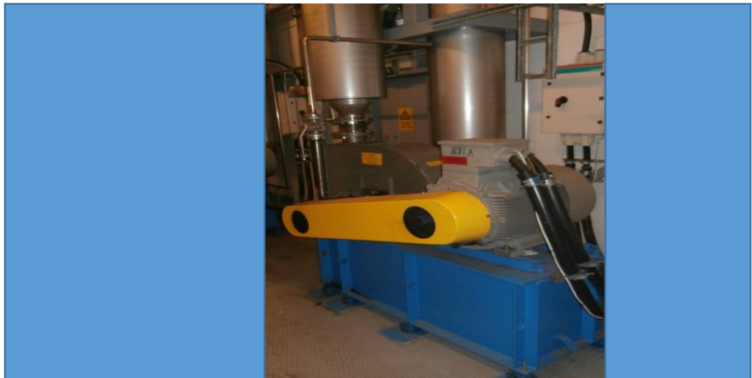
Kuva 11 FIMA off-gas-puhallin 831 A
