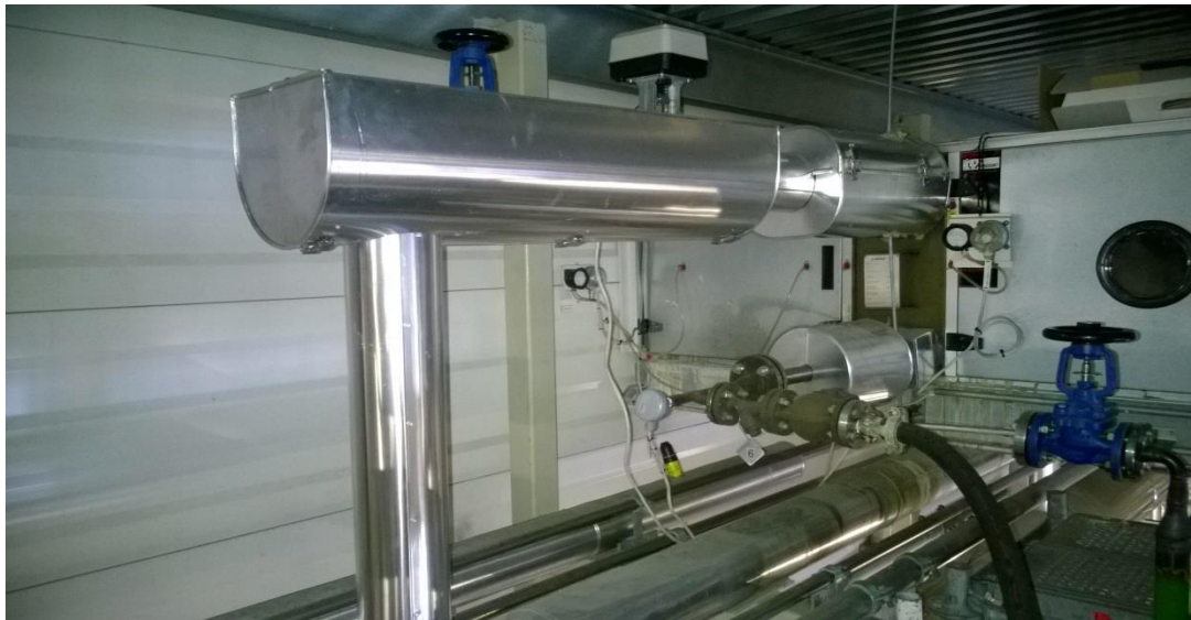
Kuva 19 Säiliöalueen ilmastointikoje ja lauhteenpoistin nro 006
