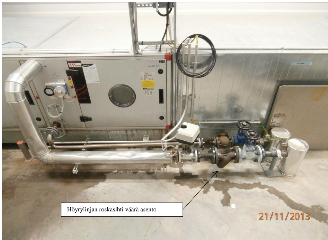
Kuva 28 Toimistojen tilailmastoinnin lämmitys (poistin nro 24)
