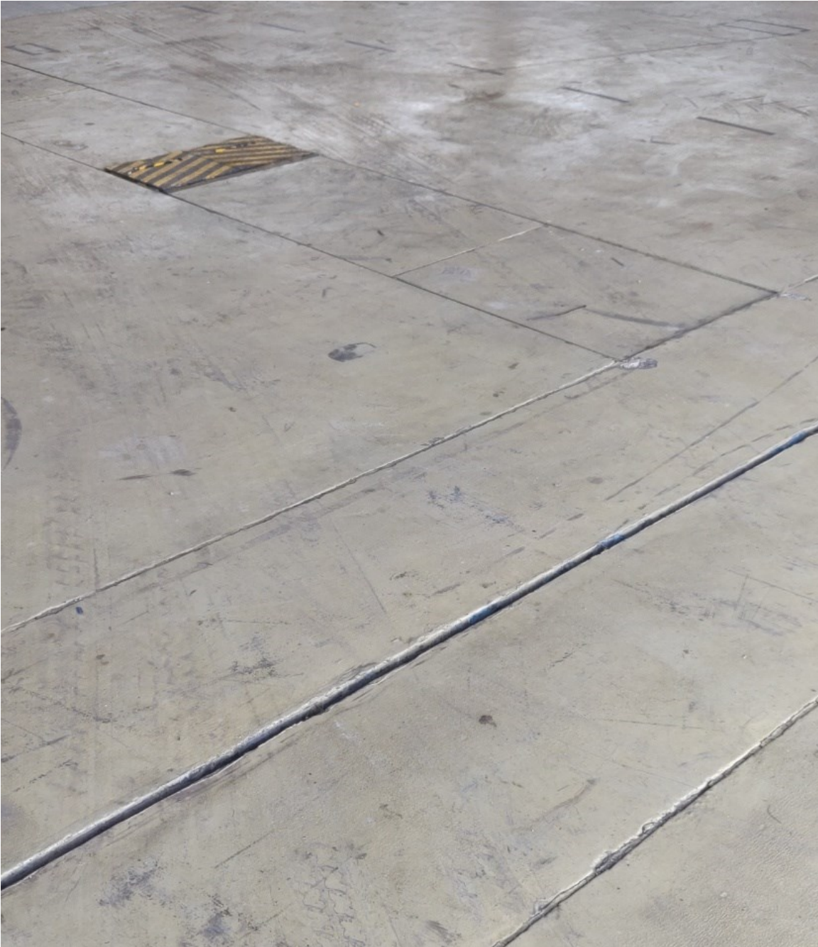
Kuva 4. Tuotantotilan lattian huolto- ja tuuletuskuilut.
