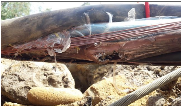
Kuva 22. Kaapelivaurio maanrakennuksen yhteydessä
