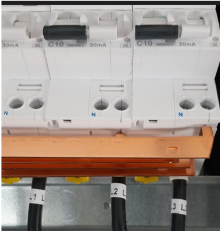
Kuva 23. Ryhmäkeskuksesta tarkastuksessa löytynyt oikosulku
