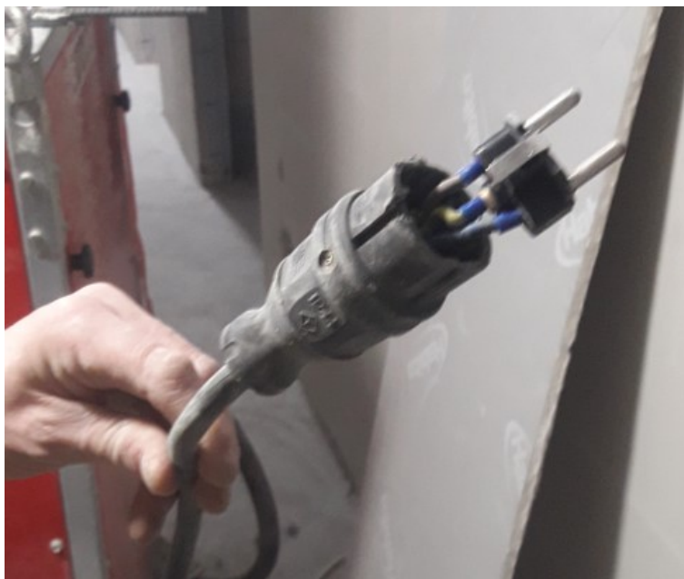
Kuva 12. Valvontakierroksella havaittu vioittunut jatkojohto
