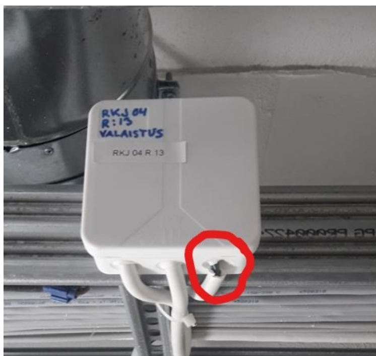
Kuva 8. Kaapeli luistanut rasiasta
