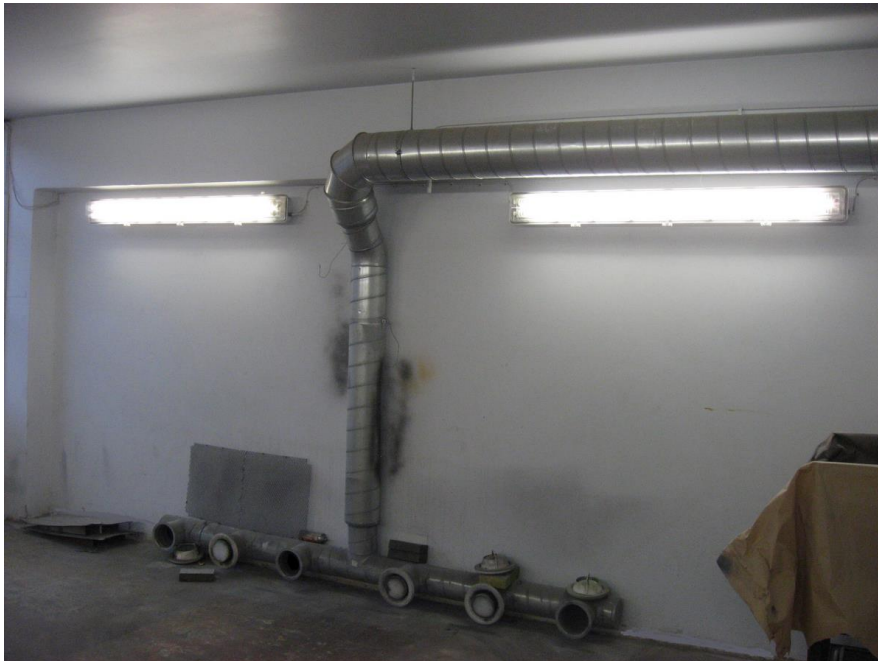
KUVIO 26. Ilmanvaihtolaitteisto ja valaistus.
