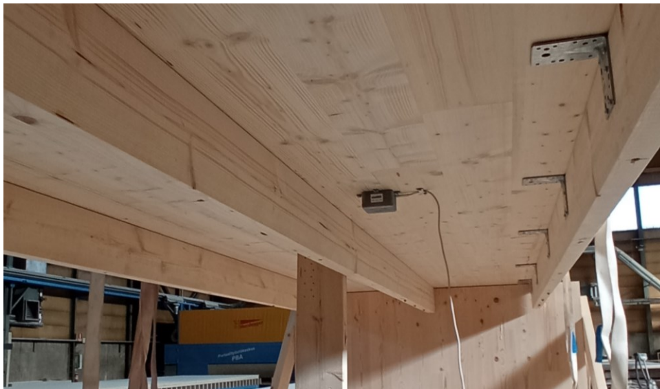
Kuva 28. Värähtelyanturi asennettuna pituussuunnassa keskelle jänneväliä.
