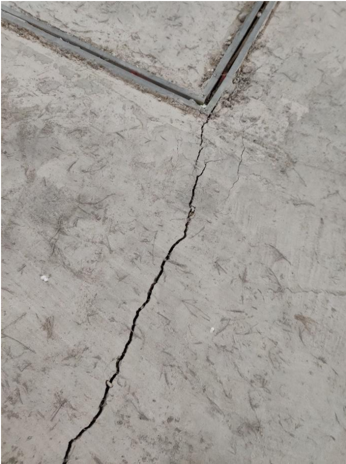
Kuva 10. Halkeama kuitubetonilattiassa (Laitila, 2022).
