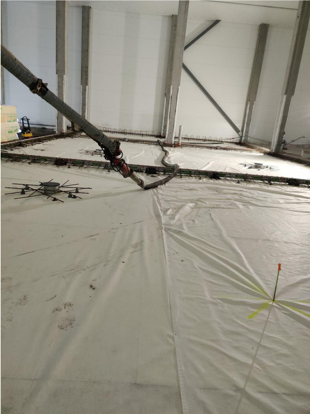
Kuva 12. Valmis pumppulinja (Laitila, 2022).
