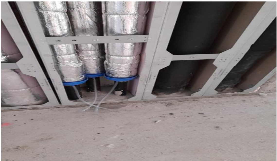
Kuva 16. Betonivälipohjan läpivientiin on valettu umpeen juotosbetonilla. [kuvaaja Hieu Tran.]
