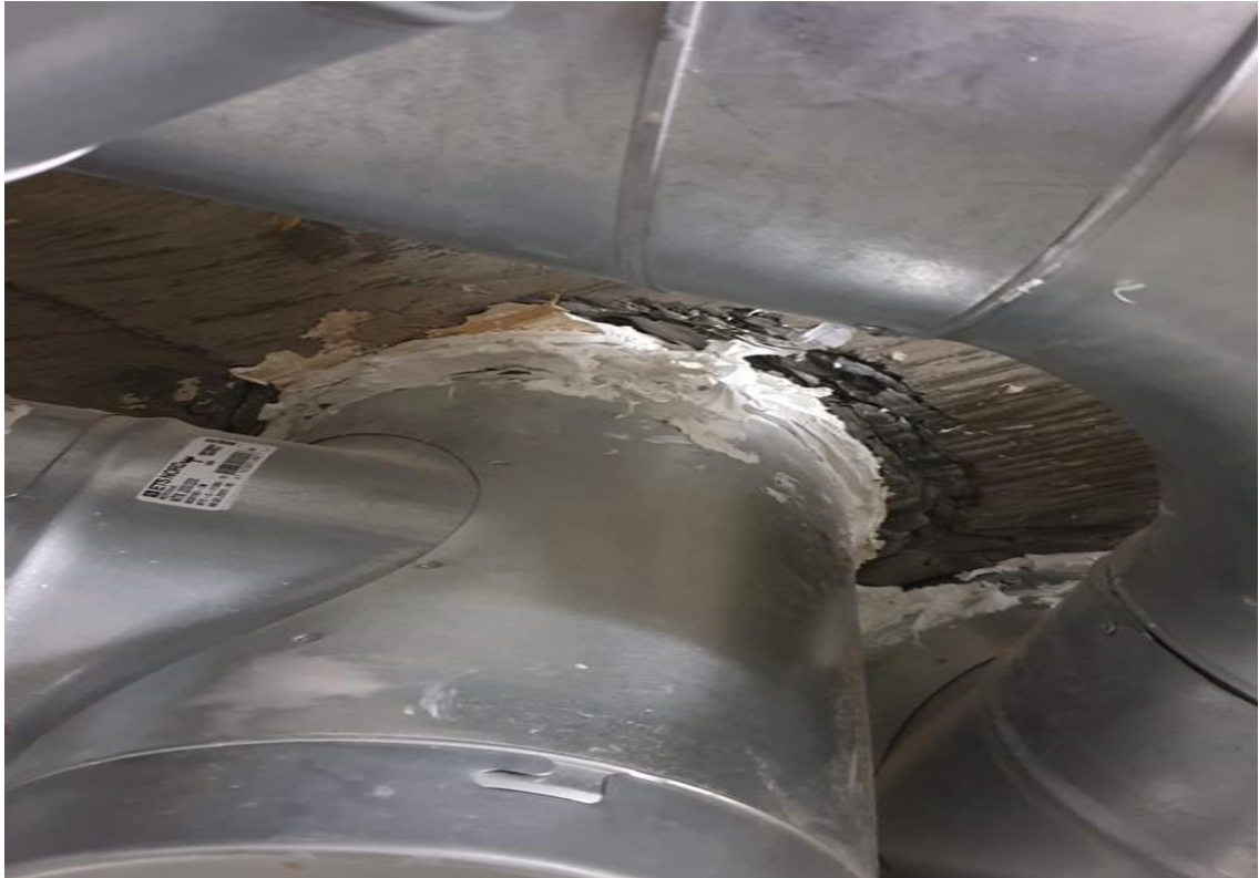
Kuva 18. Palokatossa akryyli on huonosti levitetty ja viimeistelty. [kuvaaja Hieu Tran.]
