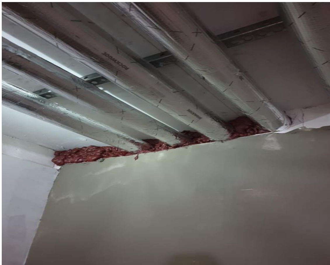
Kuva 13. Palokatkovaahdolla toteutettu palokatko seinäläpiviennissä. [kuvaaja Hieu Tran.]
