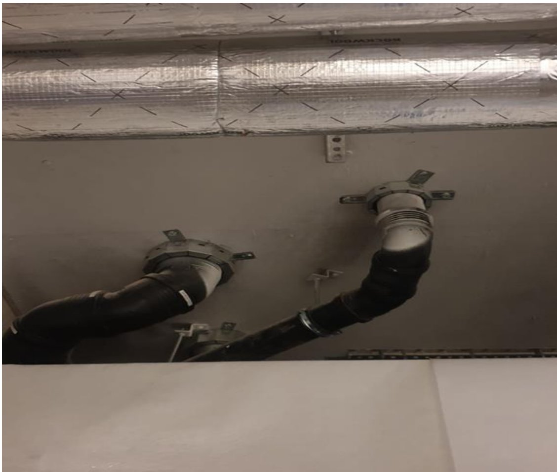
Kuva 9. Palomansetit ovat asennettu muoviputkiin betonivälipohjassa ahtaassa tilassa. [kuvaaja Hieu Tran.]
