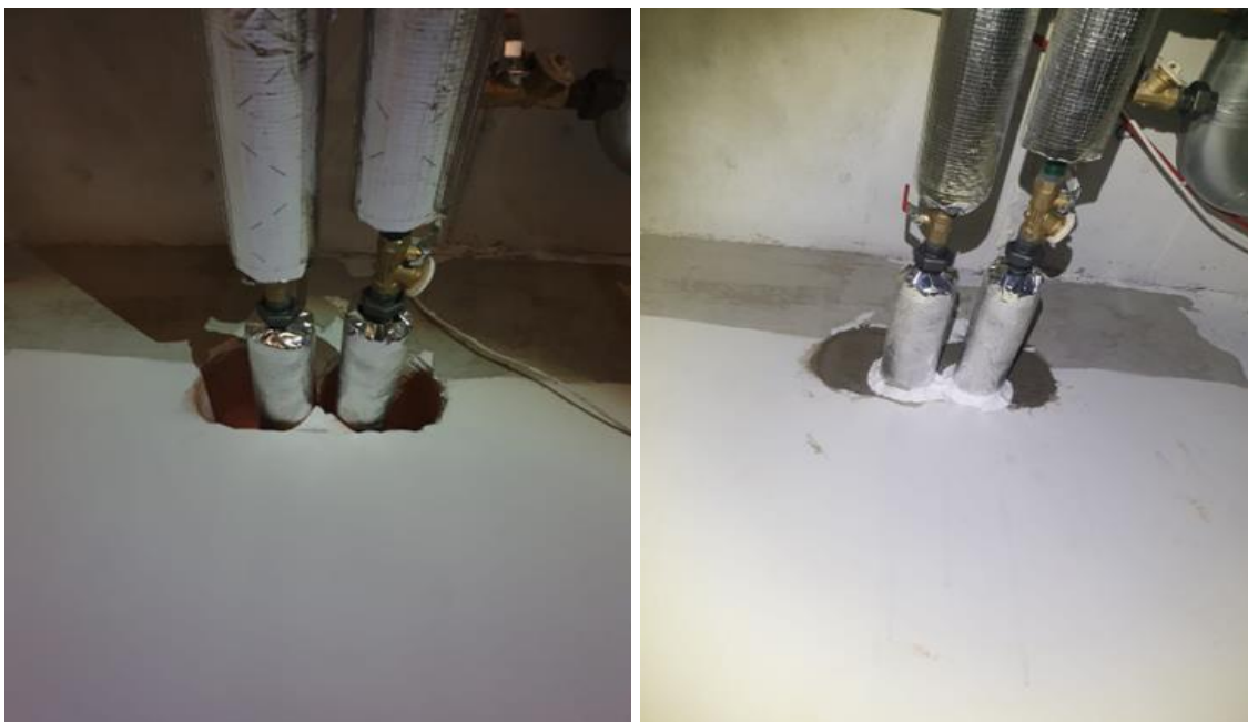
Kuva 19. Suunnitteluvirheen takia putkiläpimenot ovat porattu liian isoksi. [kuvaaja Hieu Tran.]
