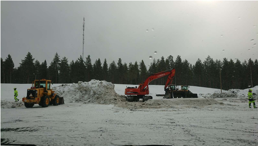
KUVA 5. Maarakennuskoneiden käytön harjoittelua talvisissa olosuhteissa. Lumi on erinomainen maa-ainesten korvike silloin, kun sulaa maata ei ole tarjolla. Lumella voidaan harjoitella erilaisten rakenteiden mittatarkkaa rakentamista, harjoitella lastaamista, vaakakoneiden käytön harjoittelua. Mittatarkkojen rakenteiden rakentamisessa harjoitellaan yhtäaikaaisesti muun muassa koneiden käyttöä, mittalaitteiden käyttöä, korkopisteen siirtoa ja tiimityöskentelyä. (Palovaara 2022)
