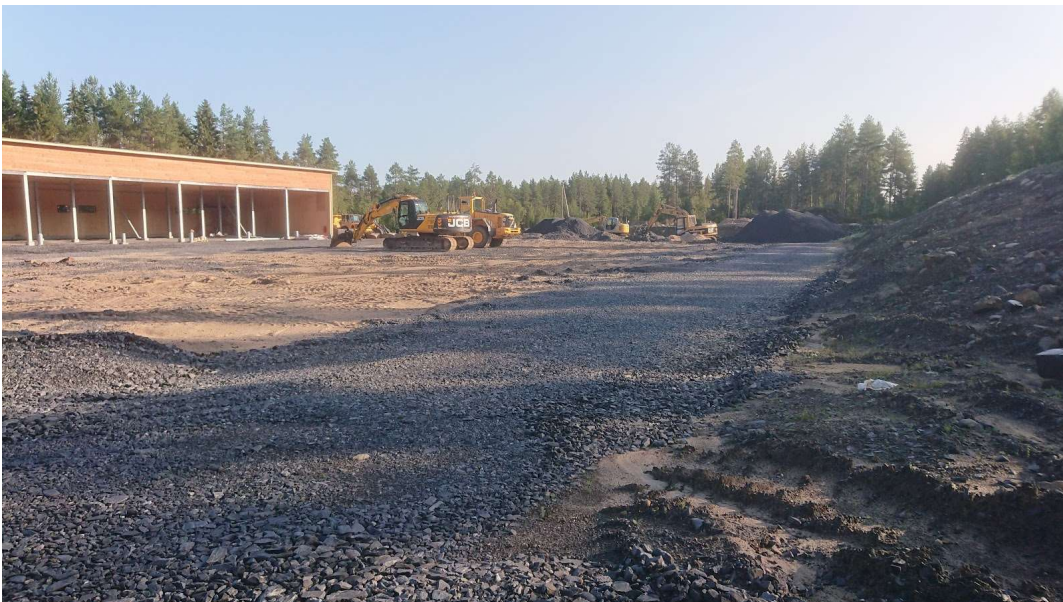
KUVA 4. Vasemmalla alueen luoteisrajalla oleva konekatos, edessä keskellä hiekkapintainen harjoittelualue ja oikealla kuvassa alueen kaakkoisrajalla oleva maavalli. Hiekkakentällä voidaan harjoitella koneiden perustyöliikkeitä, koneiden siirtoja sekä erilaisten murskerakenteiden rakentamisharjoituksia. Hiekan syvyys kentällä on noin 30 cm. (Palovaara 2021)
