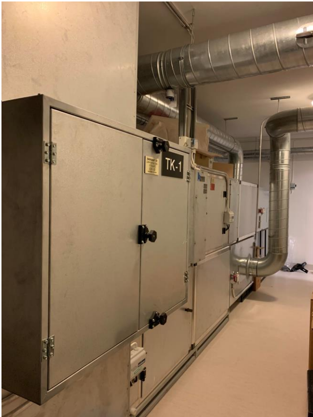
KUVA 6. Ilmanvaihtokone, joka palvelee pukuhuoneita ja niiden märkätiloja.
