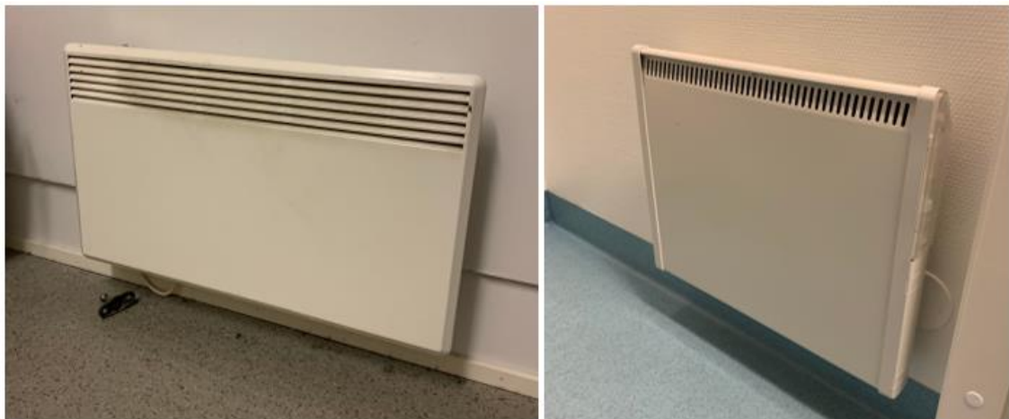
KUVA 4. Vasemmalla alkuperäiset Nobo electron sähköpatterit, ja oikealla kahvion rakentamisen yhteydessä lisätyt Ensto Finlandin sähköpatterit
