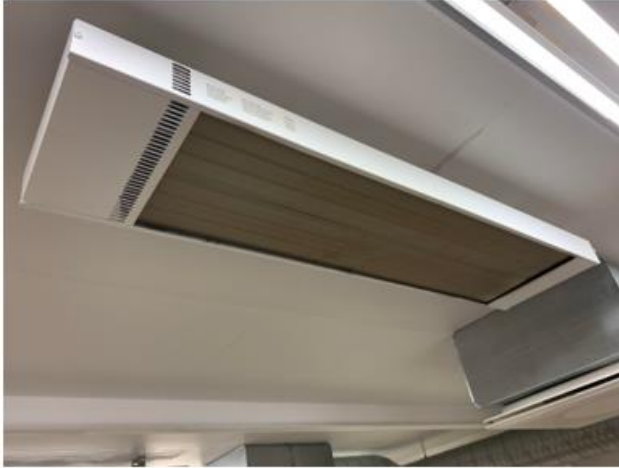
KUVA 3. Säteilylämmitin pukuhuoneen katossa
