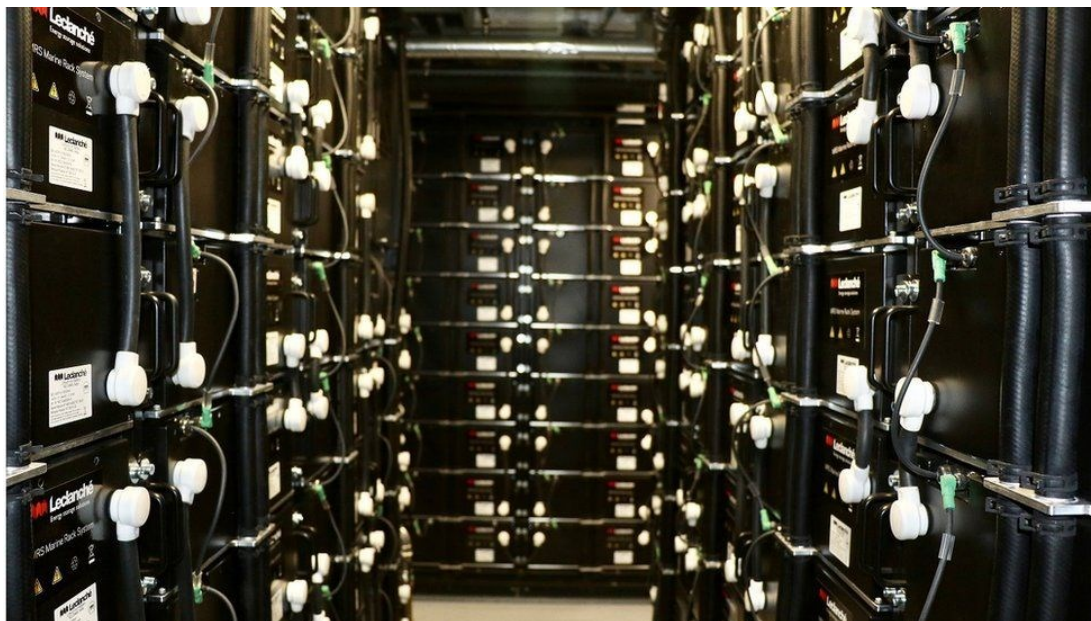
Kuva 6. Laivan akkuhuone (BBC)
