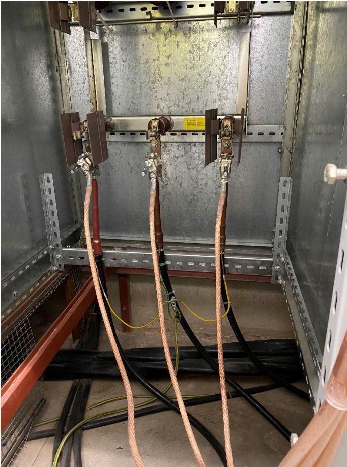
Kuvio 10. Siirrettävät työmaadoitusvälineet asennettuna kojeistoon
