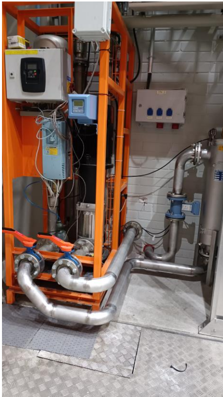
Kuva 20. Vesiaseman 4025 putkien uudet reitit ja suodatus.
