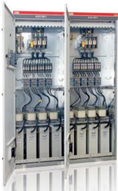
Kuva 13 MNS-kompensointikeskus (ABB Oy, 2012)
