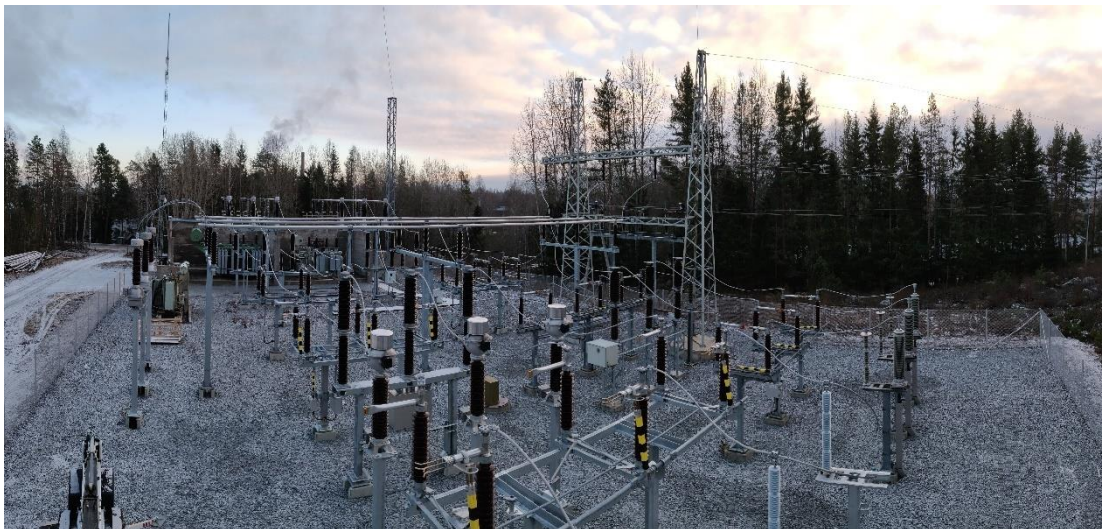
Kuva 3 Ilmaeristeinen sähköasema (Hakkarainen, 2018)
