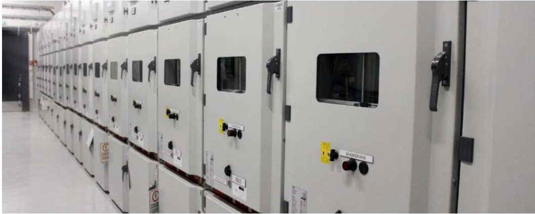
Kuva 4 20 kV kojeistoja (Tampereen Vera, n.d.)
