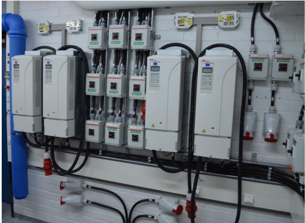
Kuva 2. Testihuoneen taajuusmuuttajat ja ulkoisten syöttöjen turvakytkimet
