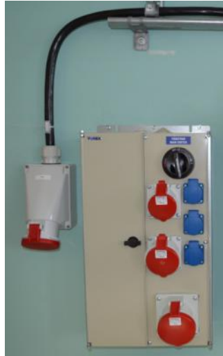
Kuva 3. Testihuoneen ulkopuolinen syöttöpiste ja voimapistorasiakeskus
