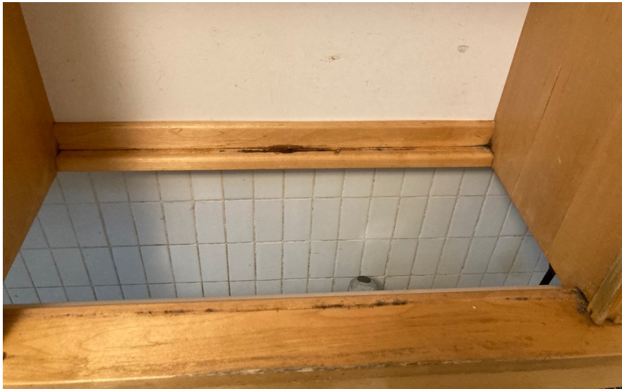
Kuva 14. Tiskialtaan kuivauskaapin kosteusvauriot näkyvät tummina kohtina puupinnassa.
