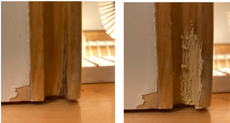
Kuvat 32. ja 33. Lohkeamasta ja maalilohkeamasta
