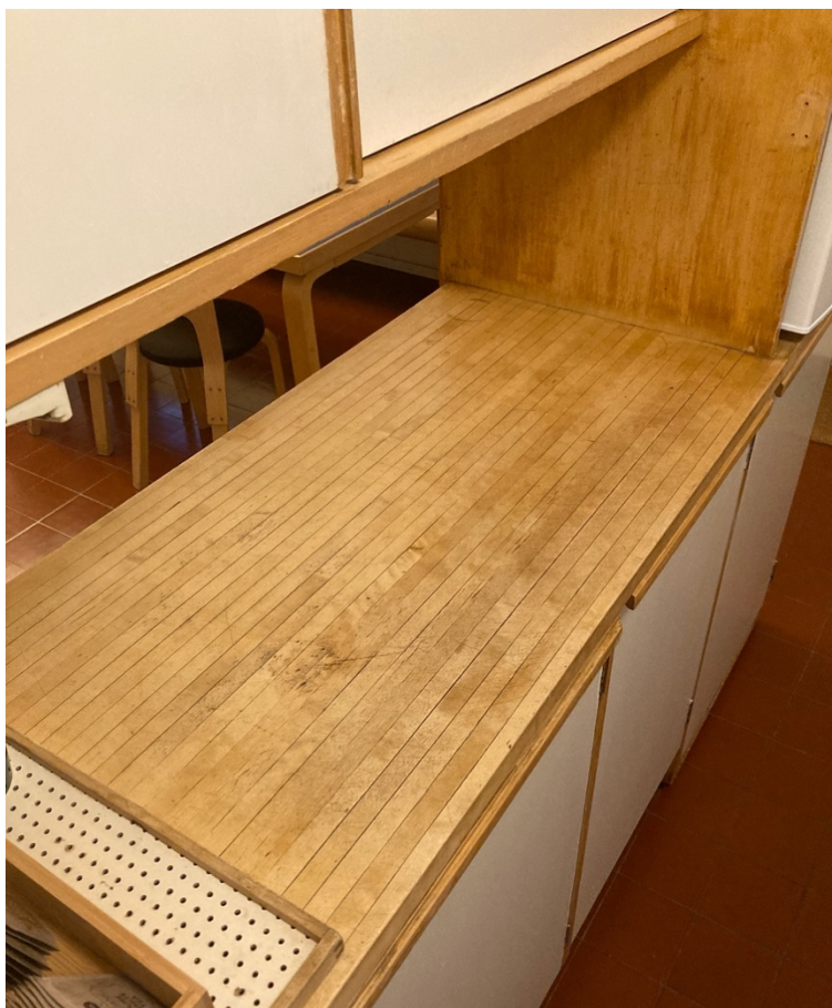
Kuva 20. Keittiön tason kulunut pinta ja vaurio jääkappi seinässä.
