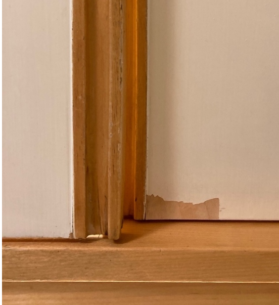
Kuva 16. Tiskialtaan yläkaapin maali on lohkeillut.
