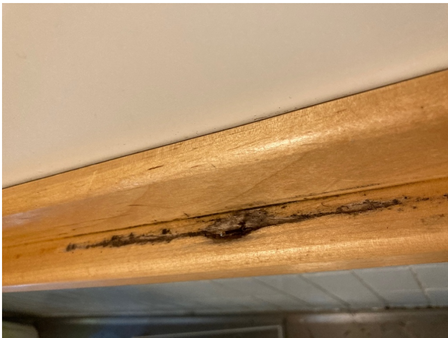
Kuva 15. Kosteusvaurio, josta vaurioitunutta puuta on aloitettu poistamaan.
