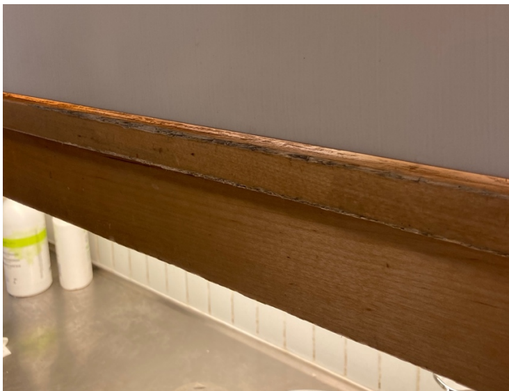
Kuva 17. Tiskipöydän kohdalla yläkaapin profiili on kolhiintunut
