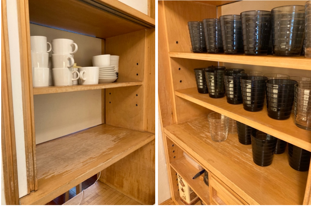
Kuvat 21 ja 22. Keittiösaarekkeen astiakaappien hyllyjen ja vedinlistojen kulumat.
