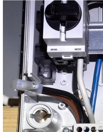
Kuva 42. Johtimet on oikosuljettu kaapelin toisessa päässä
