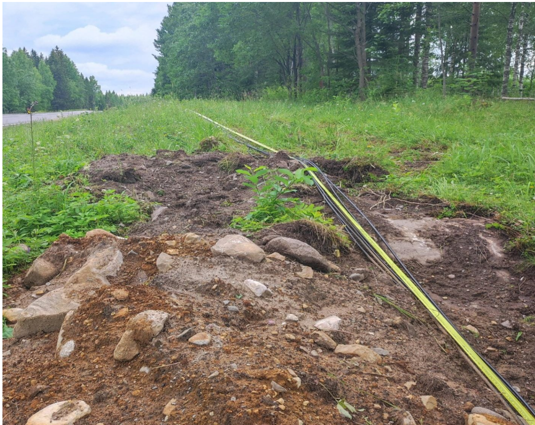
KUVA 13. Telekaapelit jätetty ns. hankikaapeleiksi, koska kohta louhittiin ennen kuin kaapelit saatiin asennettua vaadittuun syvyyteen
