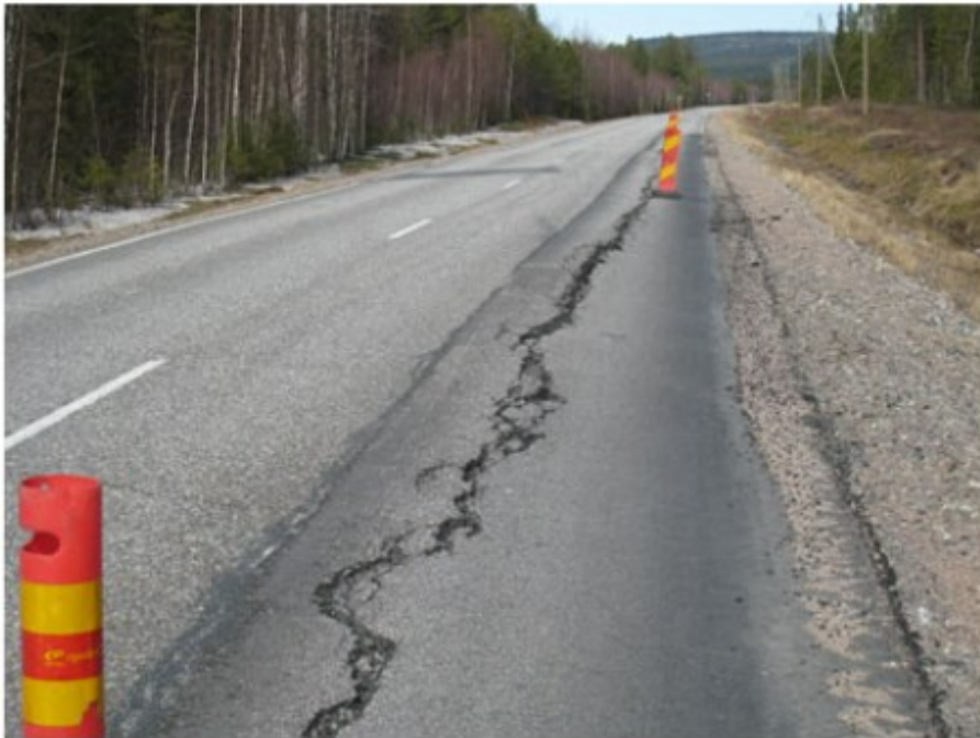
KUVA 4. Teräsverkkojen käytöllä voidaan ehkäistä kuvassa näkyvä routanousun aiheuttama vakava vaurio vanhan tierakenteen ja levennetyt osan välillä (Saarenketo, Varin 2019, 31.)
