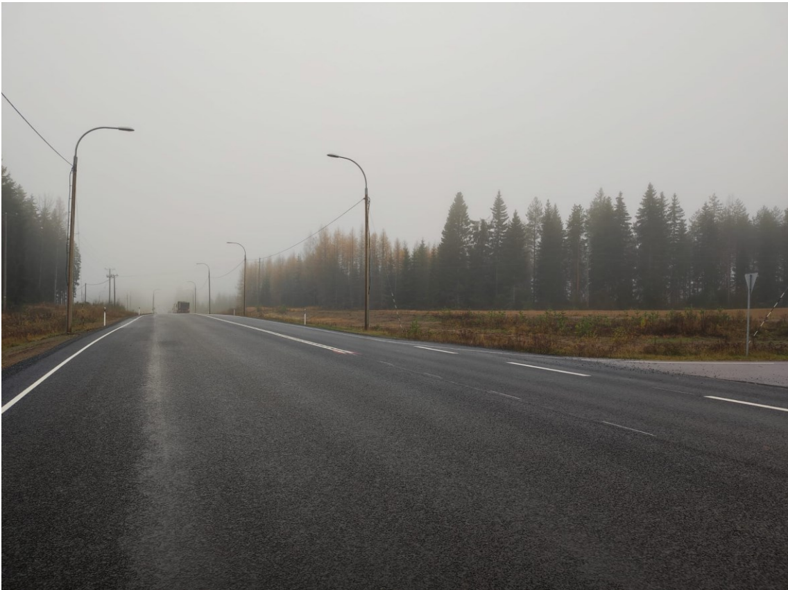
KUVA 41. Valmis SMA-päällyste. Kuvassa näkyy myös valmiit tiemerkinnot. Tiemerkinnot eivät sisällyneet tähän urakkaan. ELY-keskus tilasi tiemerkinnot suoraan tiemerkinnotä tekevältä firmalta.
