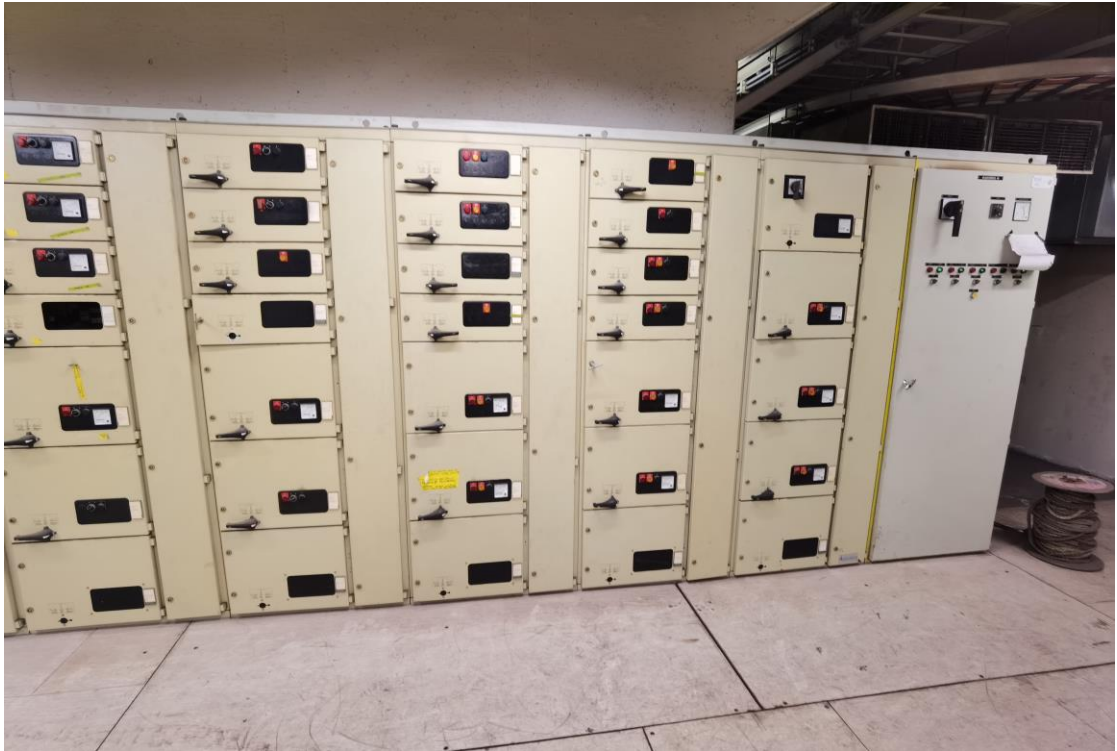
Kuva 2. Uusittavat A35 moottorikeskus ja A21 apujännitekeskus
