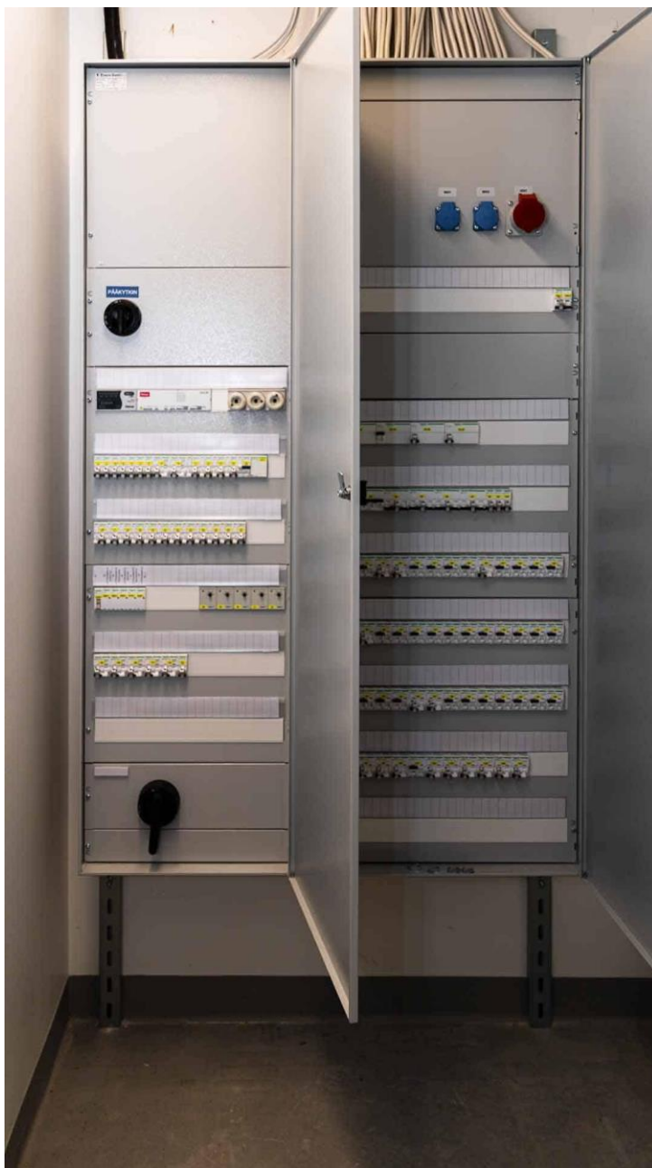
Kuva 7. Kehikkokeskus. (Kuva: https://www.eisko.fi/tuotteet-ja-palvelut/kehikkokeskukset )
