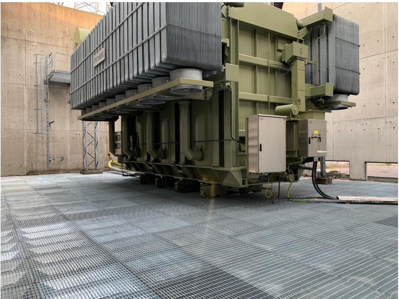
Kuva 1. Muuntaja Liekkiloukku-kokoonpanon päällä (Fintekra, 2022a)
