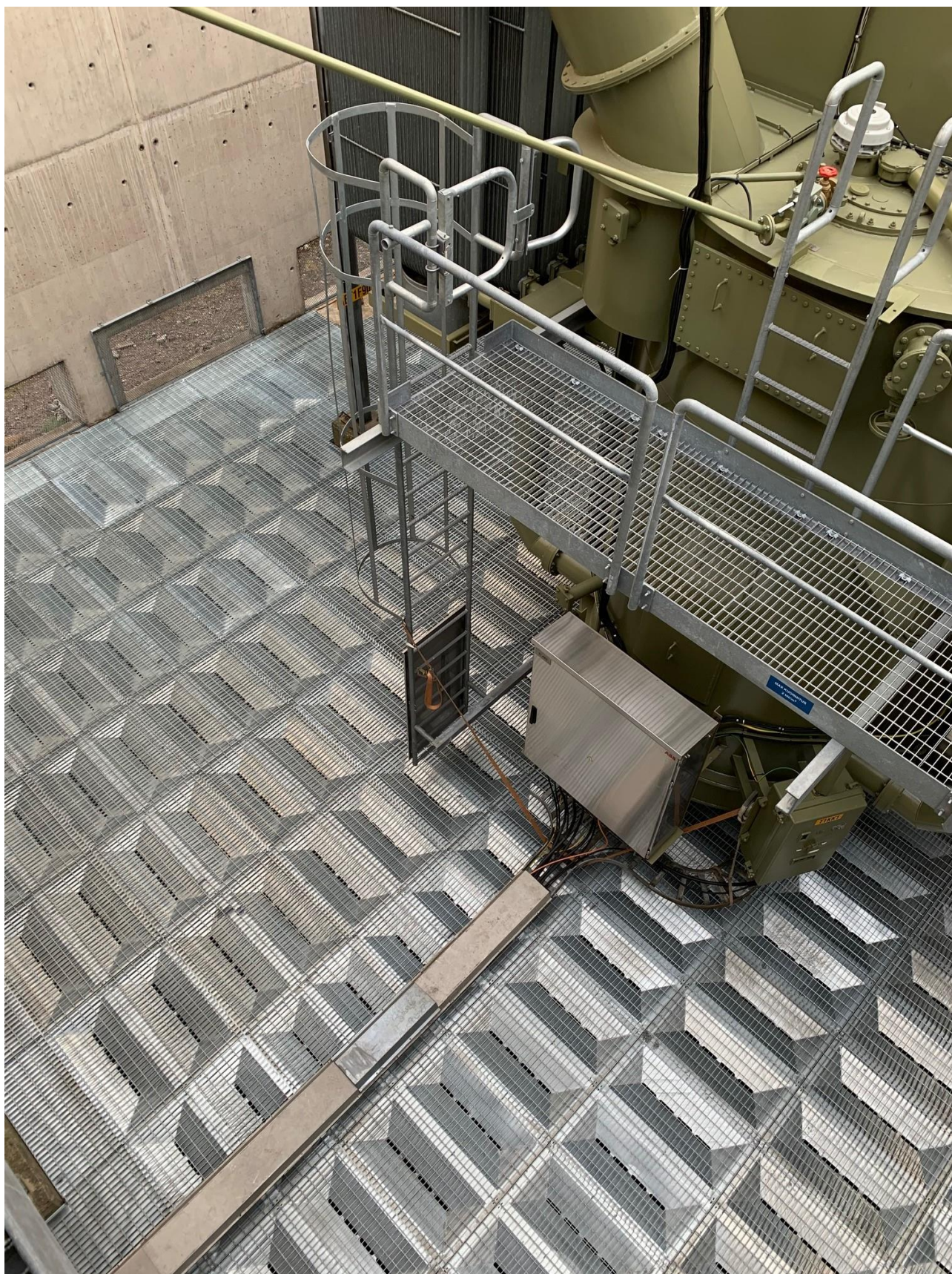
Kuva 4. Liekkiloukku-moduulin layout kokoonpano ja osa muuntajasta kuvattuna ylhäältä alaspäin (Fintekra, 2022d).
