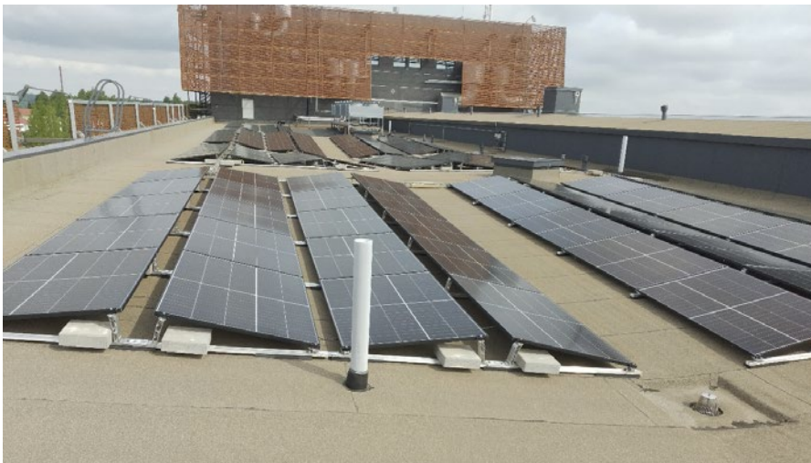
Kuva 1. SeAMKin Frami F:n katolle asennettuja aurinkopaneeleja (kuva: Kari Laasasenaho).
