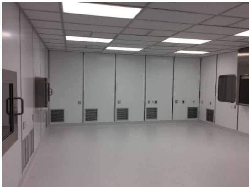
Kuva 16. Puhdastila kiinteänä huoneena. (Clean air technology inc. 2022)
