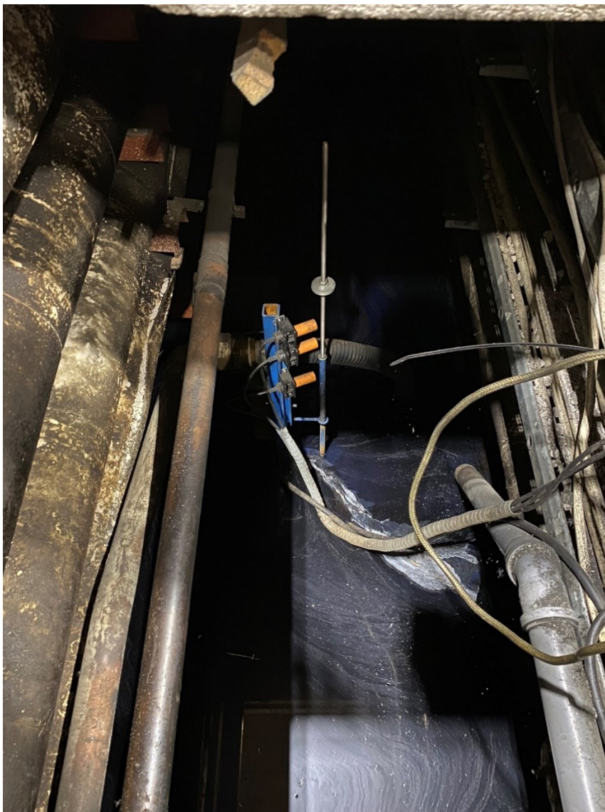
Kuva 13 Kaapelikanaalin nesteen pinta noussut rikkiäisen sähkökomponentin takia (Roope Vuori)
