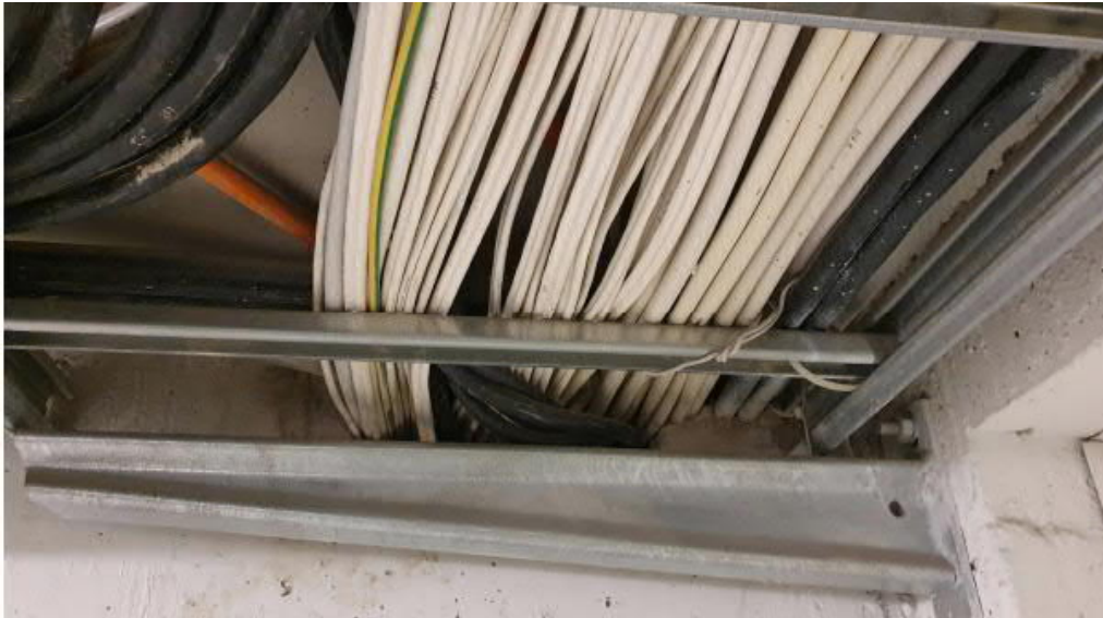
KUVA 12. Kaapeliasennuksia varastotiloissa. Kaapelihylly on täynnä ja läpivienti on tiivistämättä.
