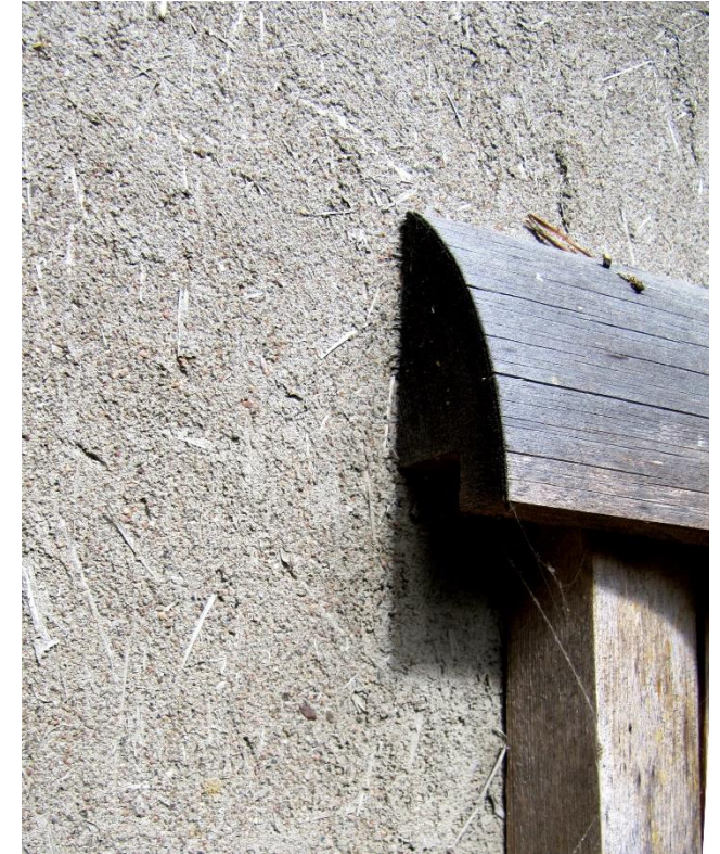
Savirakenteesta saadaan energiatehokkaampaa lisäämällä siihen orgaanista eristettä, kuten olkea. Kuva: Teuvo Ranki Kuva 3
