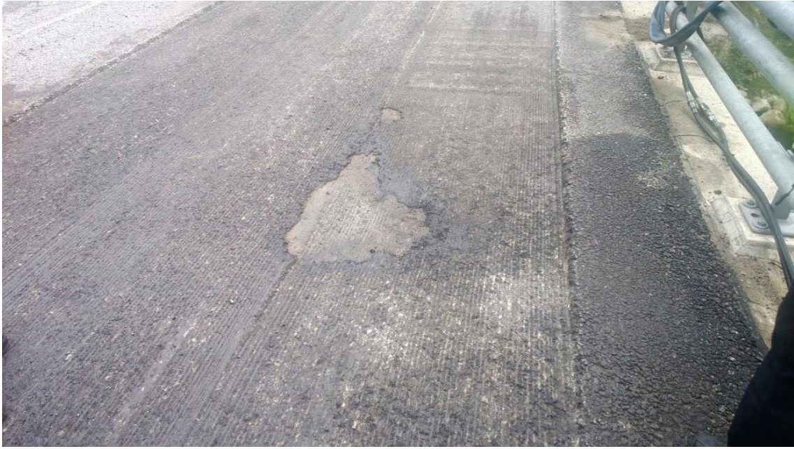
KUVA 8. Kuvassa näkyy päällysteen irtoaminen suojabetonia myöten (kuva Jouni Juurikka)
