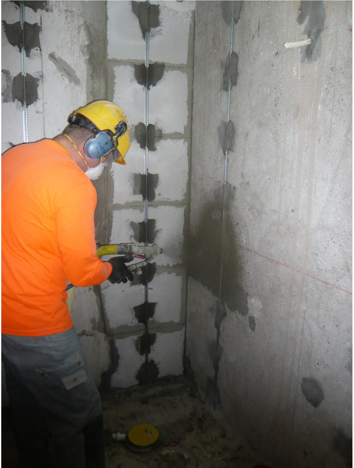
Kuva 2. Oikaisutasoitusta ruiskulla Lähderannassa. Seiniin on asennettu rappausjohteet suoraan linjaan, jolloin seinä saadaan varmasti suoraksi.
