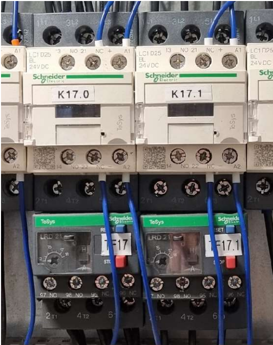
Kuvio 6. Schneider electric kontaktori ja lämpösuoja -kokonaisuus
