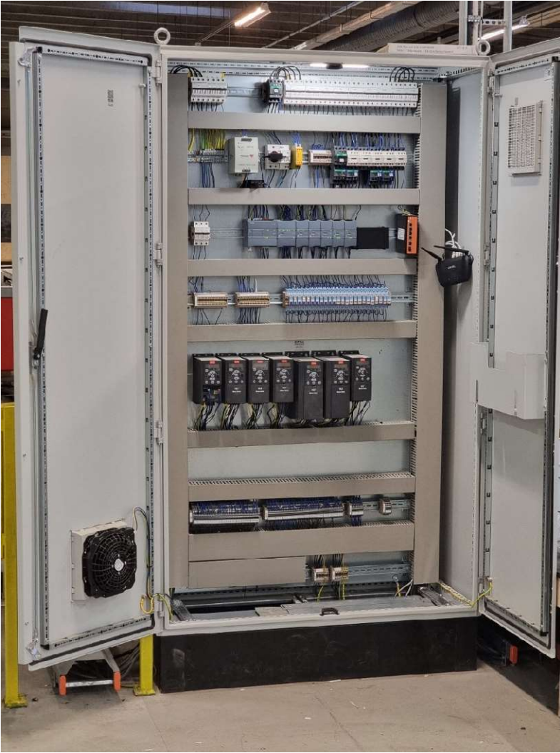
Kuvio 18. Layout-kuvan pohjalta rakennettu ohjauskeskus.
