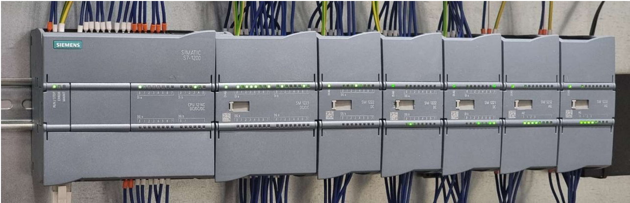
Kuvio 11. Ohjauskeskukseen asennettu Siemens-logiikkakokonaisuus
