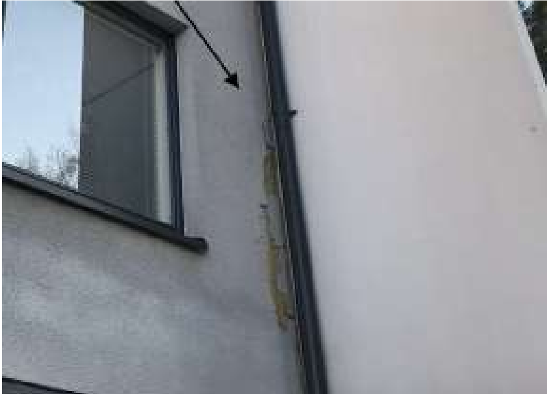
Kuva 11. Lähde suunnittelutoimiston korjaustyöselostus
