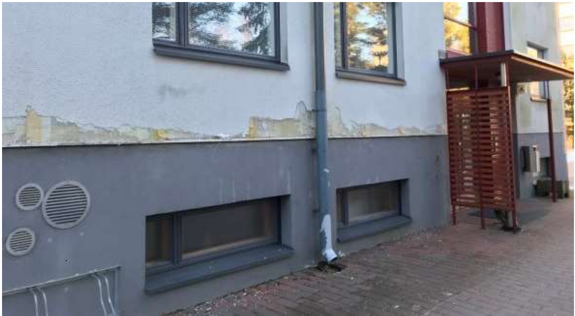
Kuva 10. Lähde suunnittelutoimiston korjaustyöselostus
