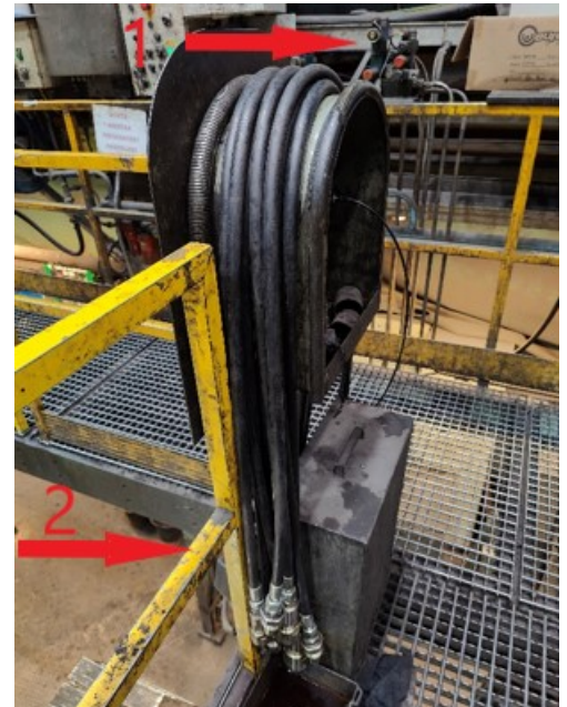
Kuva 30. Hydraulikkaletkujen säilytyspaikka. 1= JVK--4 ja -5 ja 2= JVK-6 pääsylinterien letkut.
