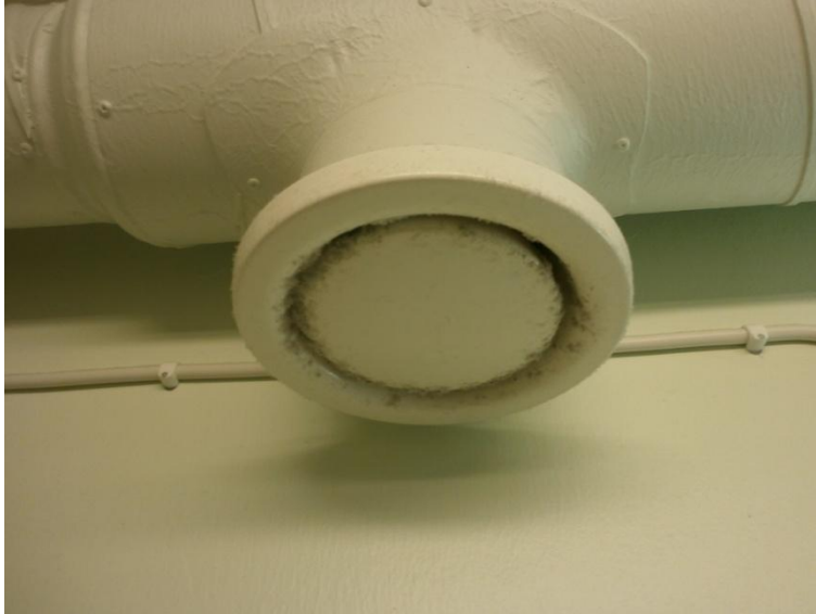
Kuvio 6. Kuivaushuoneen tuloilman päätelaite.
