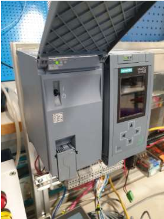
Kuva 7 SIMATIC S7-1500 PLC.
