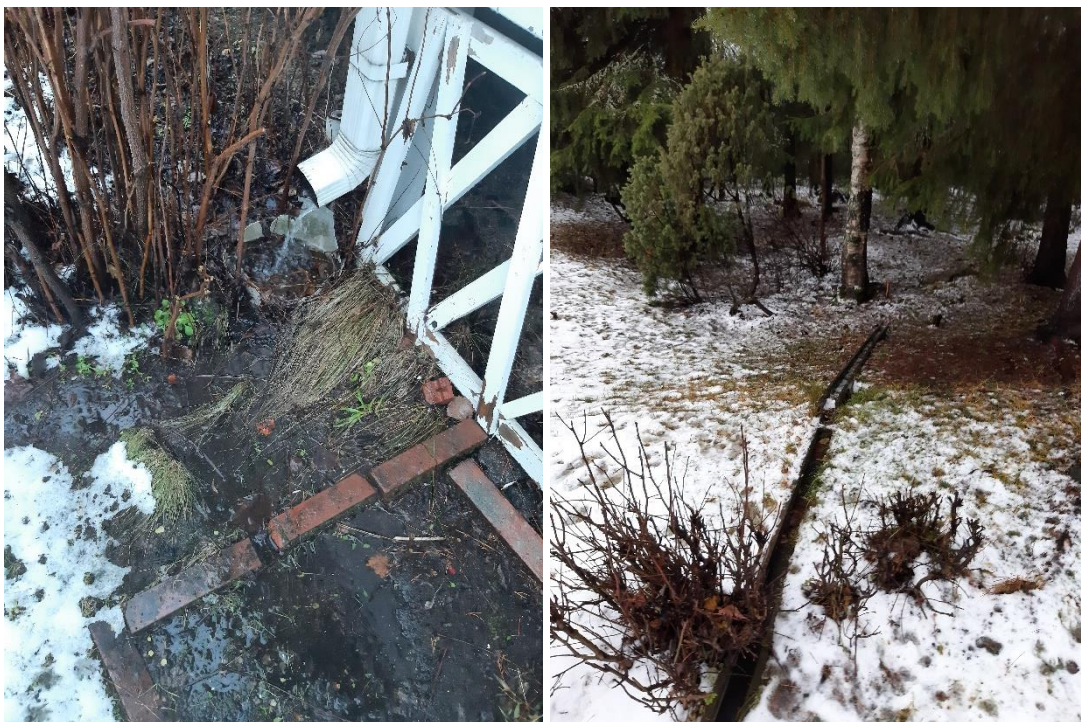
Kuva 5. Osassa A- ja B-talojen takapihojen sadevesien ohjaus on puutteellinen, joissa sadevesiä ei nykyisellään ohjata kauemmas rakennuksesta. Syöksytorni sijaitsee kuitenkin noin 2,5m ulkoseinästä (syöksytorni on terassin rungossa kiinni). Toisessa kuvassa nähtävissä C-talon sadevesien ohjaus kauemmaksi rakennuksesta puukouruihin
