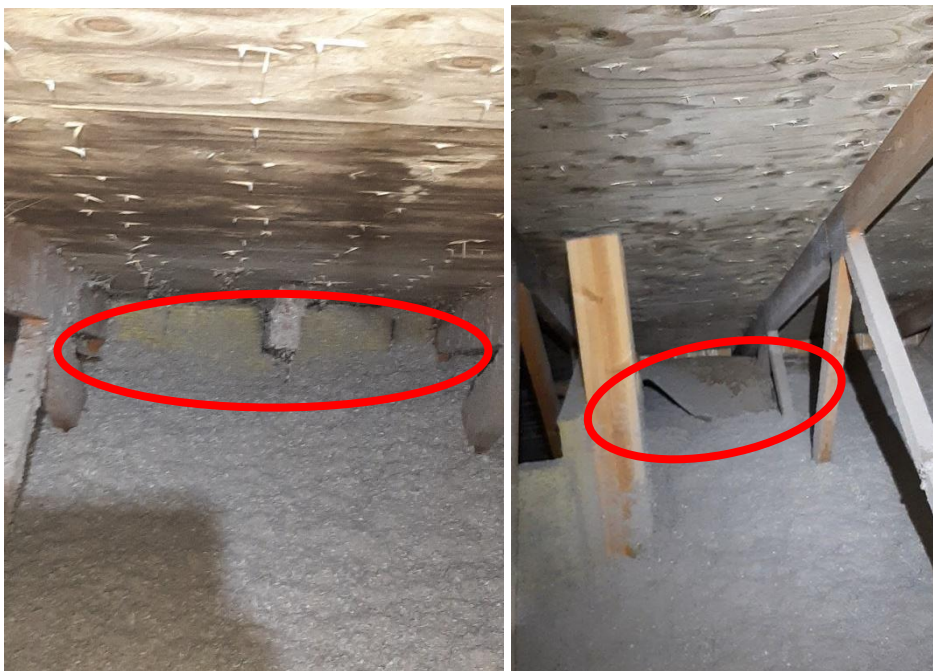
Kuva 12. Jokaisen ulkovaraston kohdalla yläpohjan tuulettuminen estynyt liian korkealle asennetun villan takia. Tämä voi aiheuttaa hajuhaittaa ulkovarastoissa. Osa tuulenojaimista irronnut
