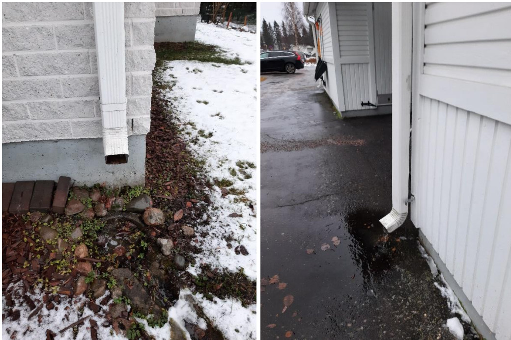
Kuva 4. Etupihojen puolella katolta tulevat sadevedet jäävät rakennuksen viereen. Osassa päätyjä myös liuskekivi ohjaus sadevedelle
