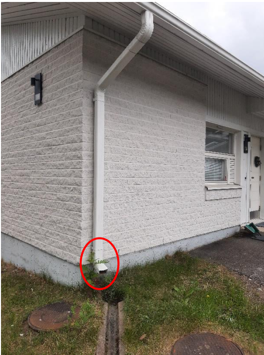
Kuva 14. Avaus tehtiin ympäröidylle alueelle, jossa on sadevesien aiheuttamaa kosteuskuormitusta
