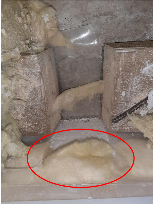
Kuva 17. Höyrynsulkumuovi viety tiiviisti alapohjan lämmöneristeiden väliin. Ympyröidystä villaerotuskaistaleesta otettiin näyte mikrobialyysiä varten. Villa on asennettu höyrynsulun "sisäpuolelle" eli siitä on ilmayhteys sisäilmaan
