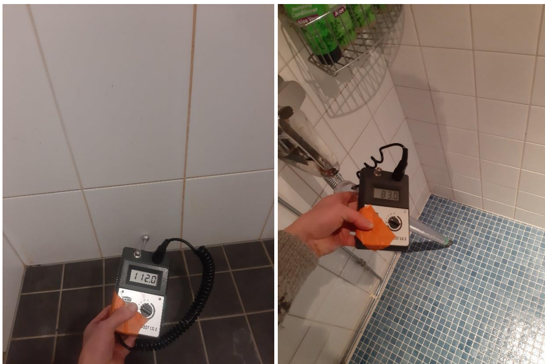
Kuva 23. Yleiskuvaa kartoitettujen kylpyhuoneiden pintakosteuskartoituksesta. Pintakosteusarvot koholla
