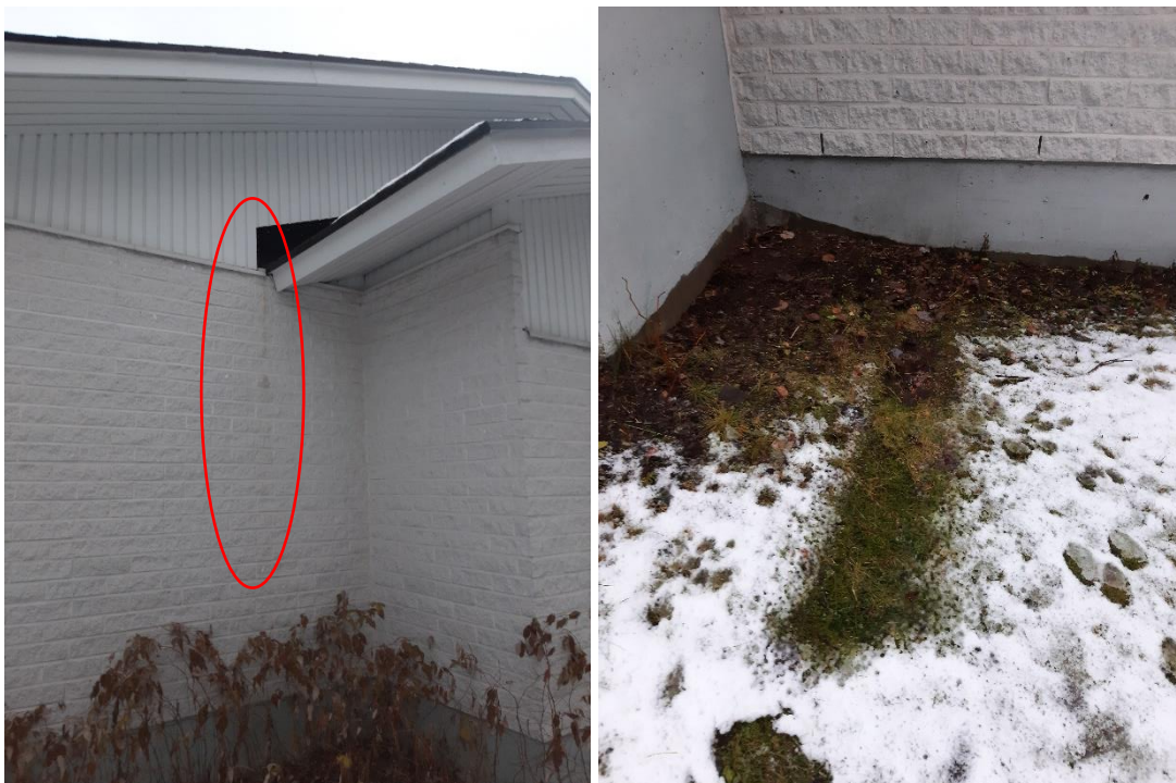
Kuva 6. Rakennusten läntisessä päädyissä vesikatoilta (makuuhuoneiden päällä) puuttuvat sadevesikourut ja rännit. Ympyröidyllä alueella nähtävissä tiilen värimuutoksia vesikatoilta tulevien vesien takia. Sadevesi tippuu perustusten läheisyyteen. Suositellaan vähintään katteen reunalle ulosheiton asennusta
