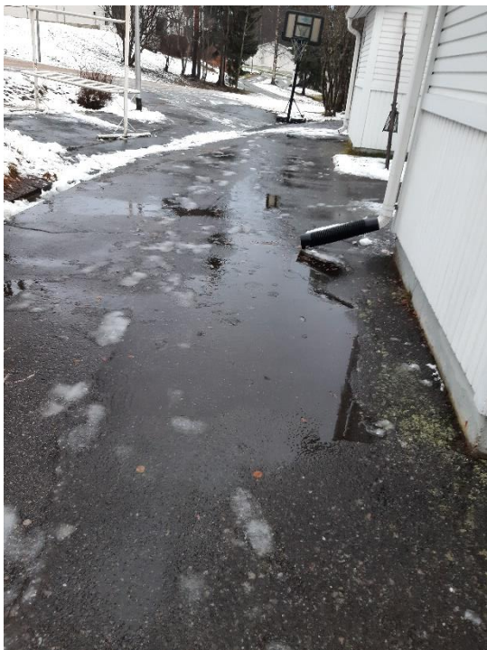
Kuva 2. Nykyisellään A-talon edustalla vesi lammikoituu puutteellisen viettojen takia
