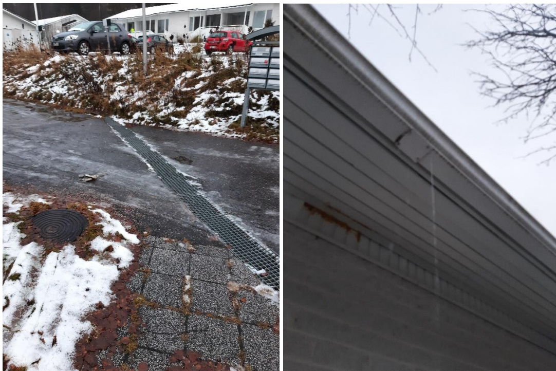
Kuva 7. Tarkastus hetkellä sadevedet pyritään ohjaamaan kulkuväylien vierellä oleviin avokouruihin. Osa tulpatuista sadevesisyoöksyistä vuotaa.
