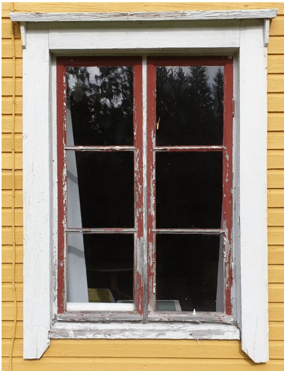
KUVA 16. Päärakennuksen ikkuna. Lounaanpuoleisten ikkunoiden kohdalla säärasitus on ollut suurinta. (Mäkinen 2022)
