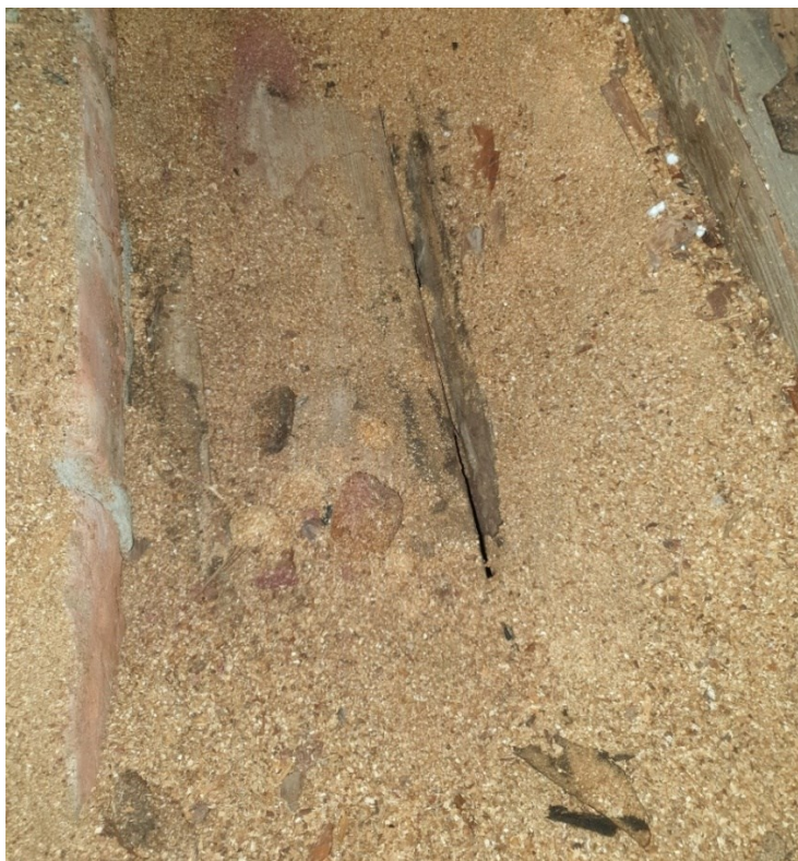
KUVA 18. Yläpohjan kosteusvaurioita. Koekuopassa näkyvissä paakkuuntunutta purueristettä, tervapaperin palasia sekä tummunutta laudoitusta. (Mäkinen 2022)
