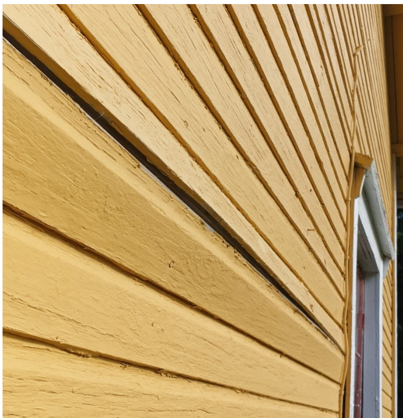
KUVA 15. Julkisivulaudoituksen pullistuma. (Mäkinen 2022)
