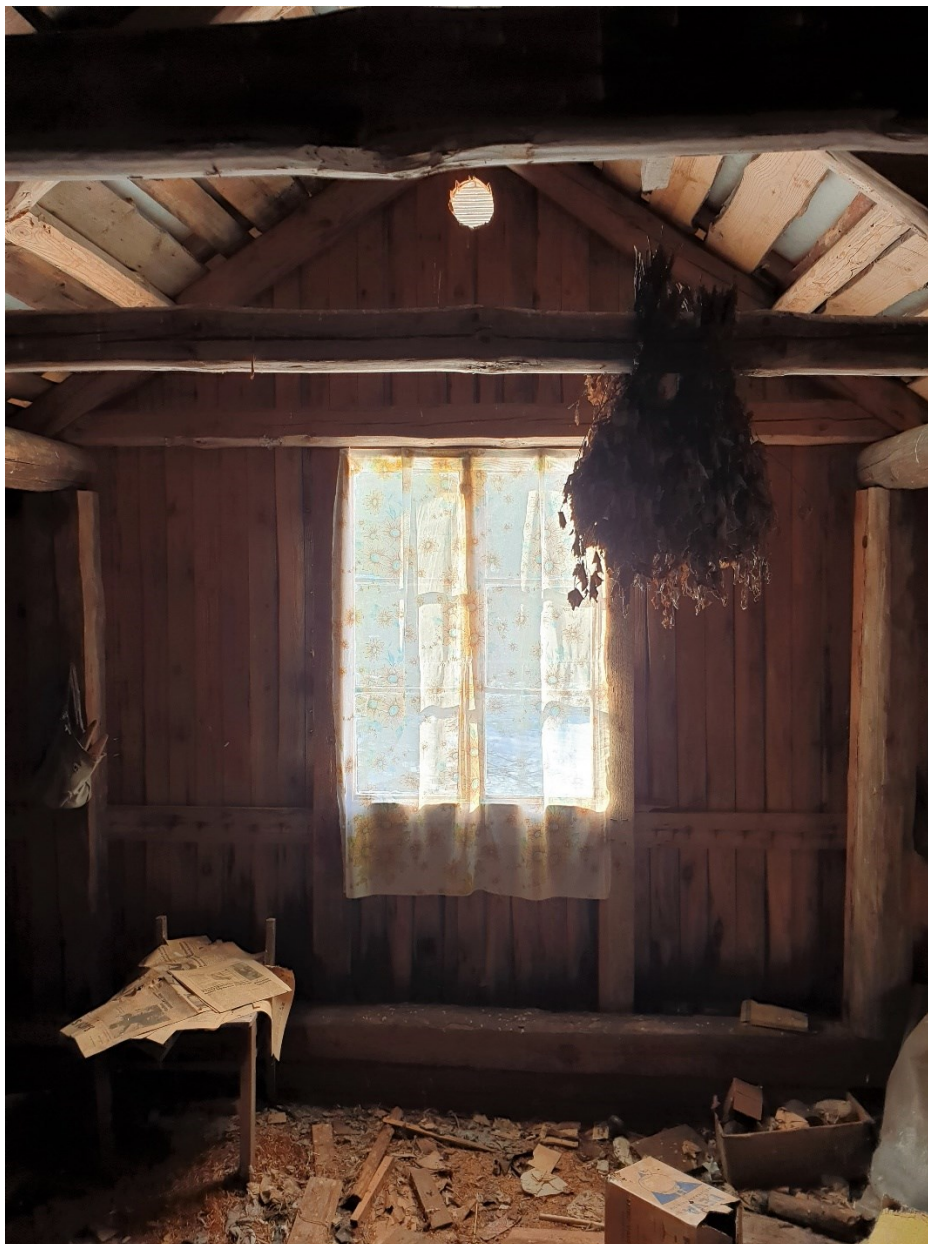
KUVA 19. Ullakon päätyseinä. Sisäpuolen pystyauoituksen alaosa on tummunut. (Mäkinen 2022)
