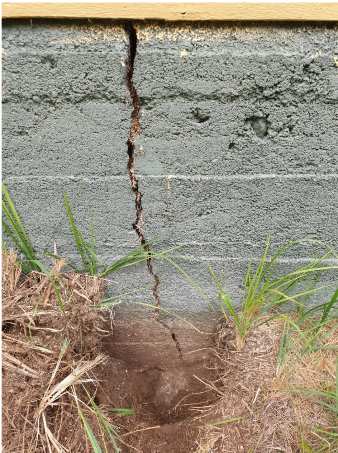
KUVA 12. Sokkelin halkeama. Koekuopassa on näkyvillä sokkeliin noussut kivi. (Mäkinen 2022)
