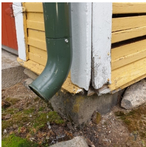
KUVA 14. Roiskeveden aiheuttamia vaurioita porstuan kulmalla. (Mäkinen 2022)
