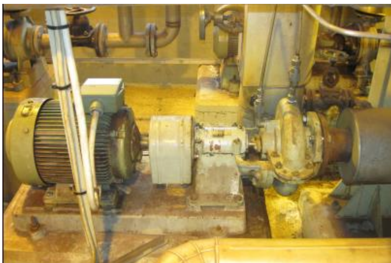
KUVA 1. Uusittava pumppu (valokuva Eetu Halonen 2014.)
