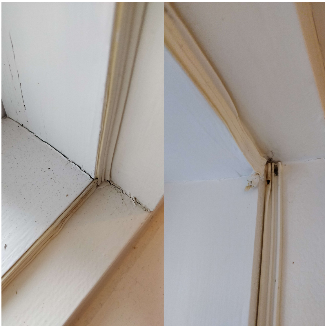
Figur 32 och figur 33. De gamla och ihoptryckta tätningslisterna i första våningens fönster.
