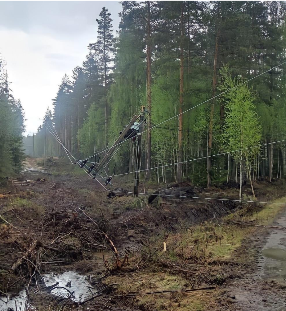
Kuvio 5. Vioittunut pylväsmuuntamo
