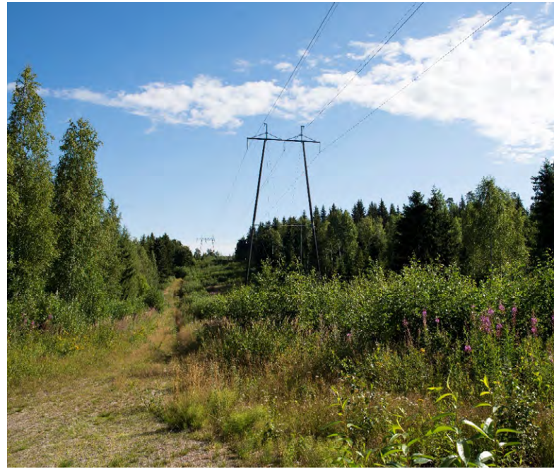
Kuva 1. Ilmajohdaja, joiden ympäristöstä on huolehdittu hyvin. Puut eivät pääse kaatumaan johtojen päälle. (Kuva: Anu Mikkola)
