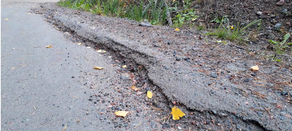
Kuva 4. Pintakelirikkoa alamäkeen johtavan tien reunassa. (Kuva: Kaisa Tuominen)
