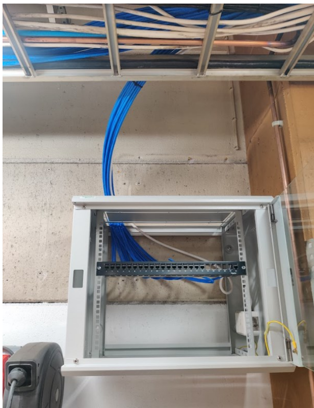
Kuva 31: Switch kaappi kaapeloituna (Torvinen 2021)
