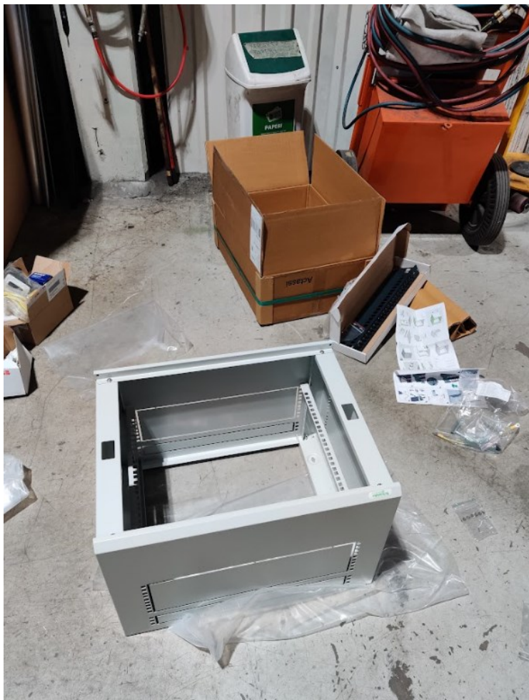
Kuva 28: Switch kaappi (Torvinen 2021)
