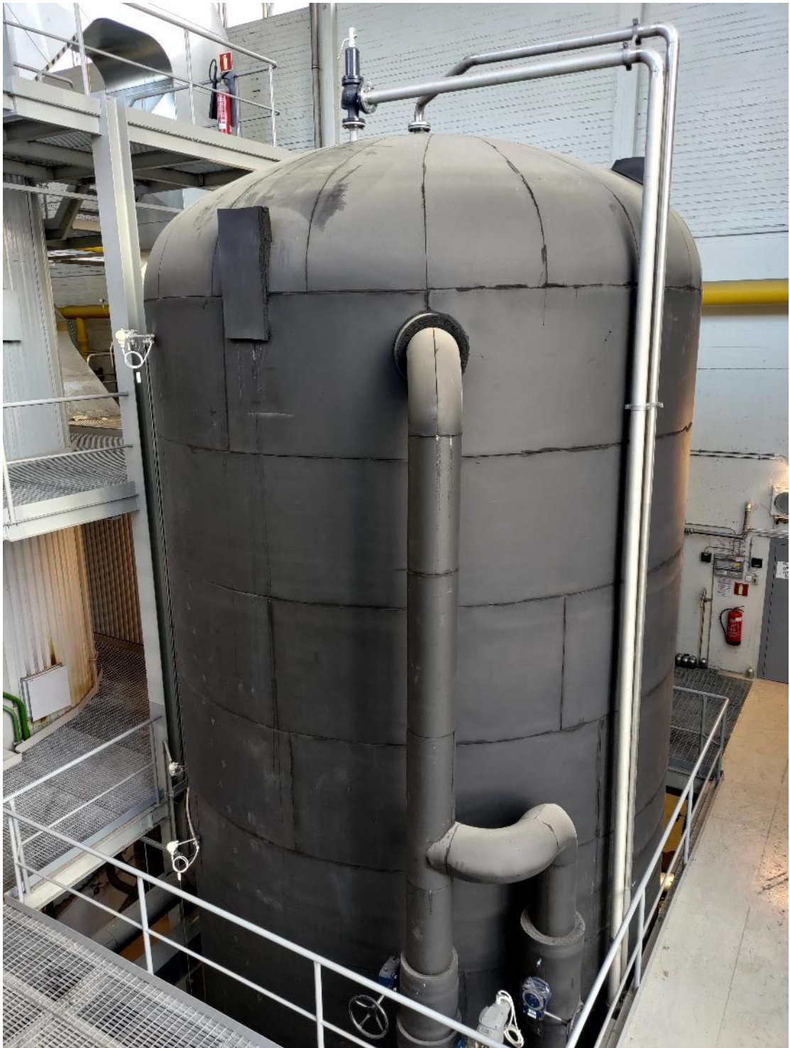
Kuva 4. Jäähdytyslaitoksen kylmäakku, jonka tilavuus on yli 160 000 litraa.
