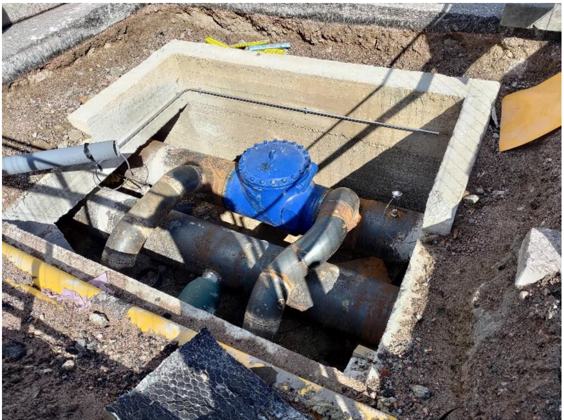
Kuva 11. Uusi lämpötila-anturi asennettu kaukolämpöverkoston paluulinjaan ennen jäähdytyslaitosta. Kapeammat putket liittävät jäähdytyslaitoksen lauhdutuksen kaukolämpöverkostoon. Sininen komponentti on takaiskuventtiili.
