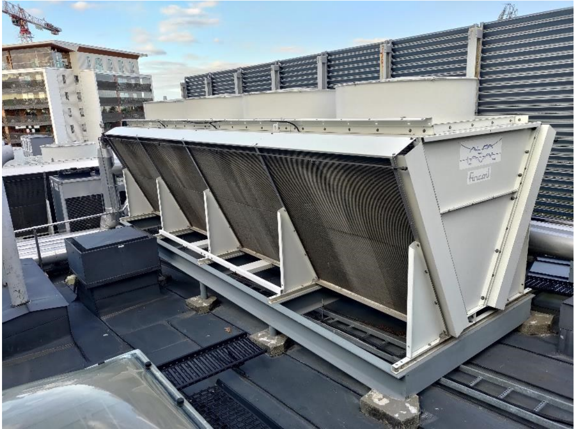
Kuva 6. Katolla sijaitseva ilmajäähdytteinen lauhdutinpuhallin
