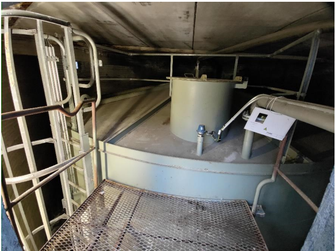
Kuva 9. Kevyen polttoöljyn säiliö varavoimageneraattoreiden dieselmootoreille. Säiliön tilavuus on 230 m 3 .
