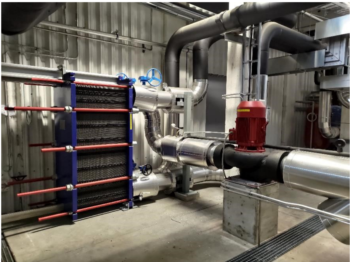
Kuva 7. Vapaajäähdytyksen lämmönvaihdin ja kierrätyspumppu, joka kierrättää jäähdytysvettä vapaajäähdytyksen lämmönvaihtimelle.
