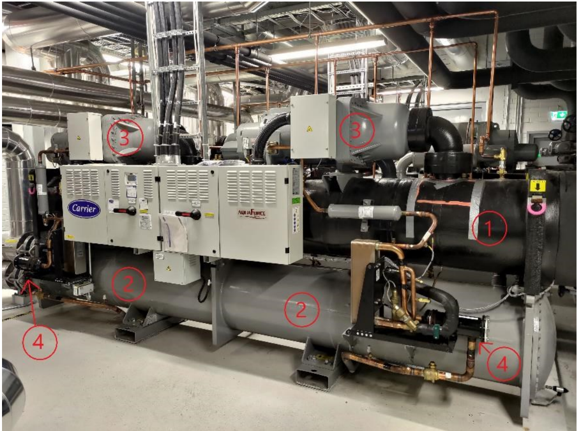
Kuva 2. Carrier 30XW lämpöpumppu sisältää kaksi erillistä piiriä, jotka pystyvät toimimaan itsenäisesti.
