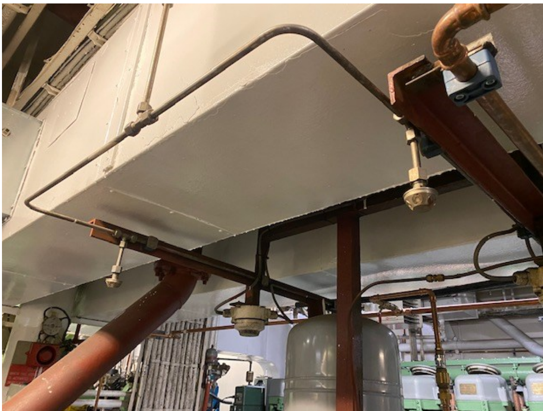
Kuva 10. Vesisumun linjasto laivan apukoneen yllä (Rautalin 2023).
