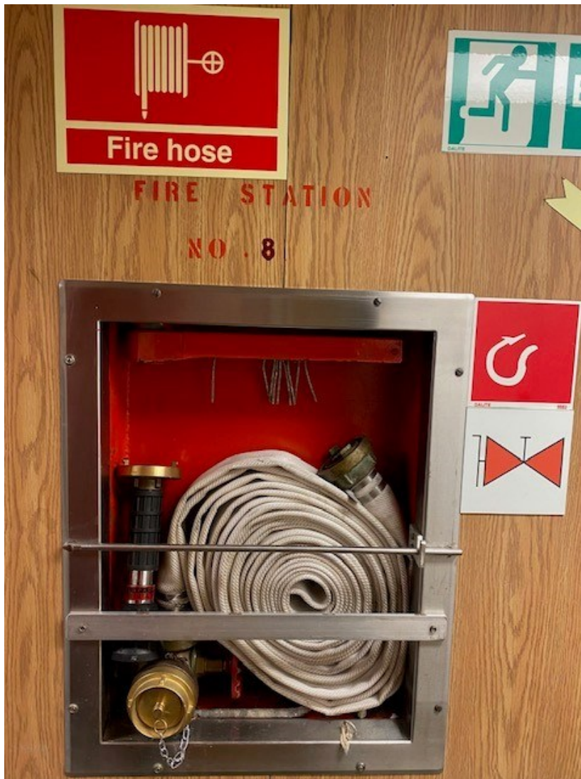
Kuva 13. Laivan käytävällä sijaitseva paloposti (Rautalin 2023).
