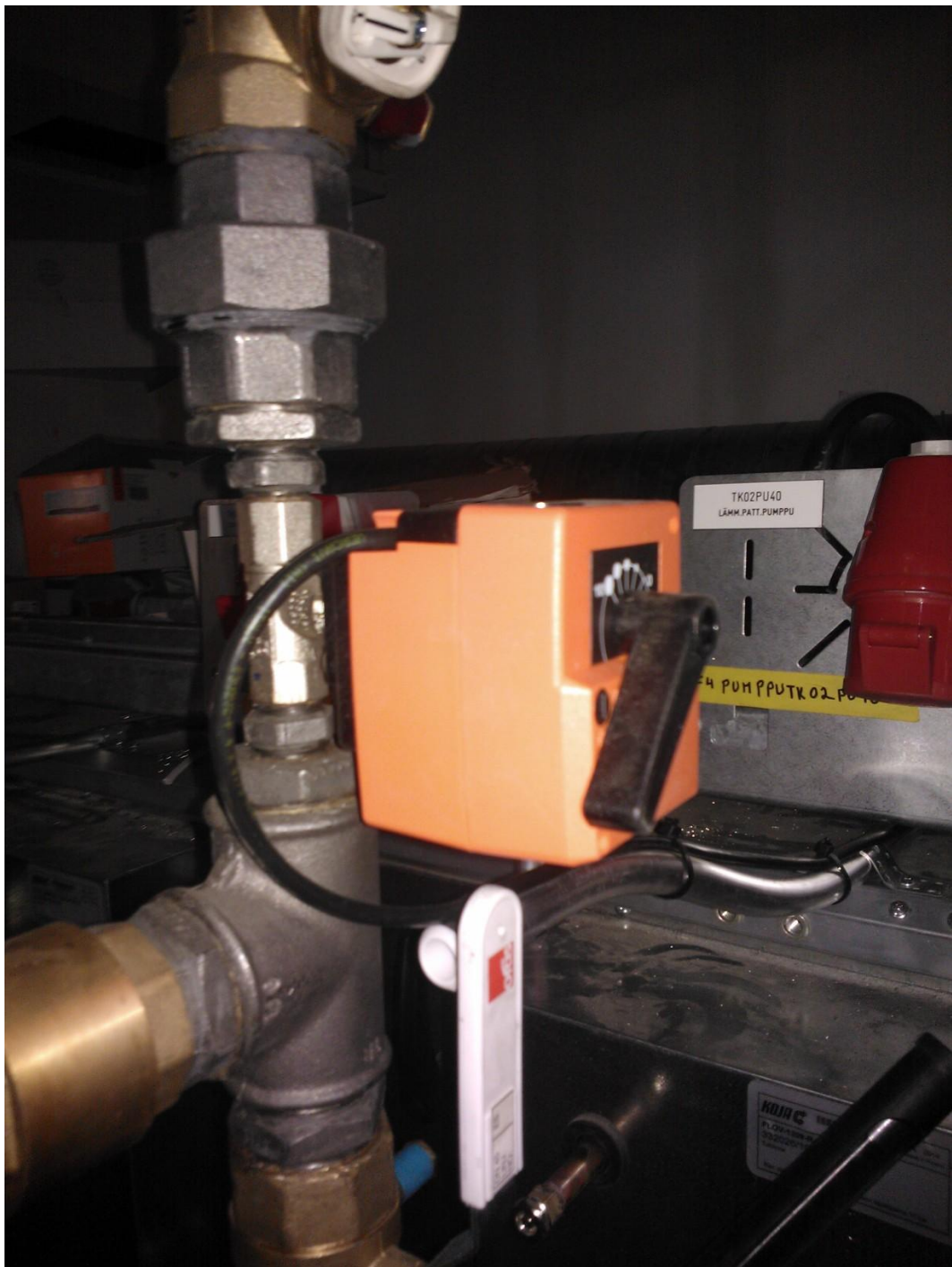
Kuvio 27. TK02TV45-lämmitysventtiili ja venttiilimoottori.
