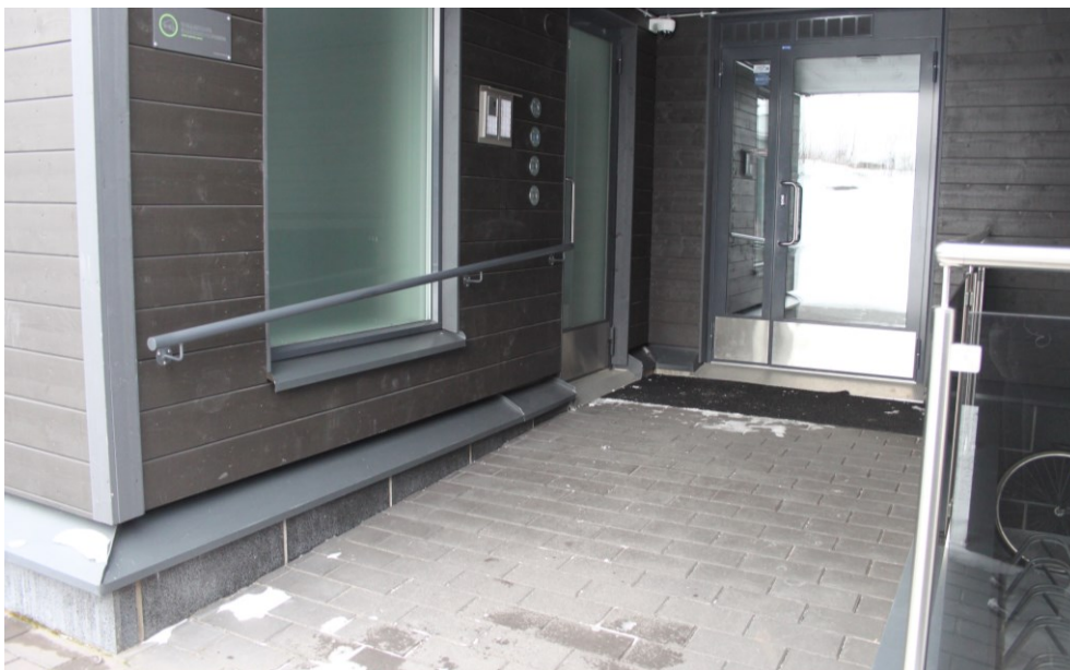
Kuva 31: Asuinkerrostalo, Tampere, 2019. Muiden puutteiden lisäksi, myös kohteen kynnykset olivat korkeita sekä käsijohteet puutteelliset. (Kuva: Hautasuo, 2023)
