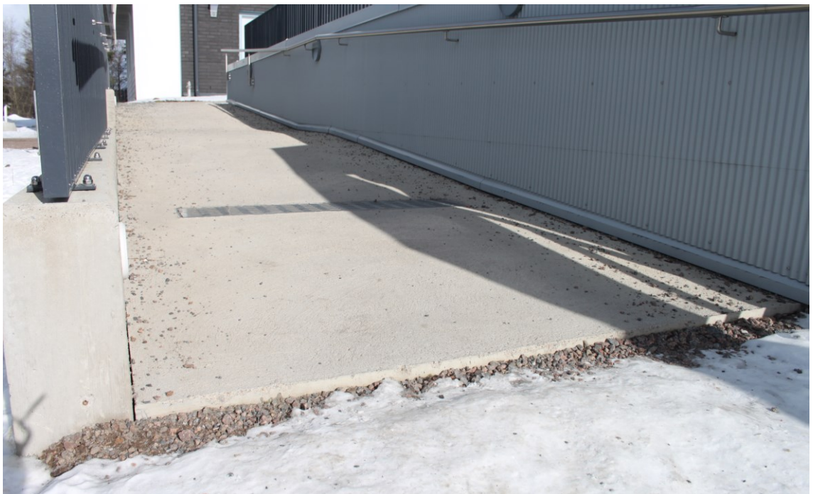
Kuva 24: Asuinkerrostalo, Tampere, 2020. Asuinkerrostalon pääsisäänkäynnille ja sisäpihalle vievässä luiskassa on kynnyks, joka on korkea ja vaikea ylittää pyörätuolilla. Käsijohteet ovat vain yhdessä korossa, mutta jatkuvat yhtenäisinä koko luiskan ajan. (Kuva: Hautasuo, 2023)
