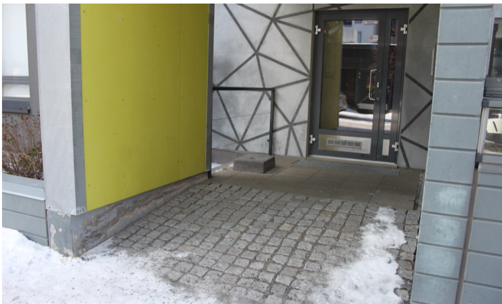
Kuva 29: Asuinkerrostalo, Tampere, 2022. Pääsisäänkäynnille vievä luiska on pintamateriaaliltaan vaikeampi käyttää kuin täysin tasainen luiska. Luiskassa ei myöskään ole käsijohteita kummallakaan puolella. (Kuva: Hautasuo, 2023)
