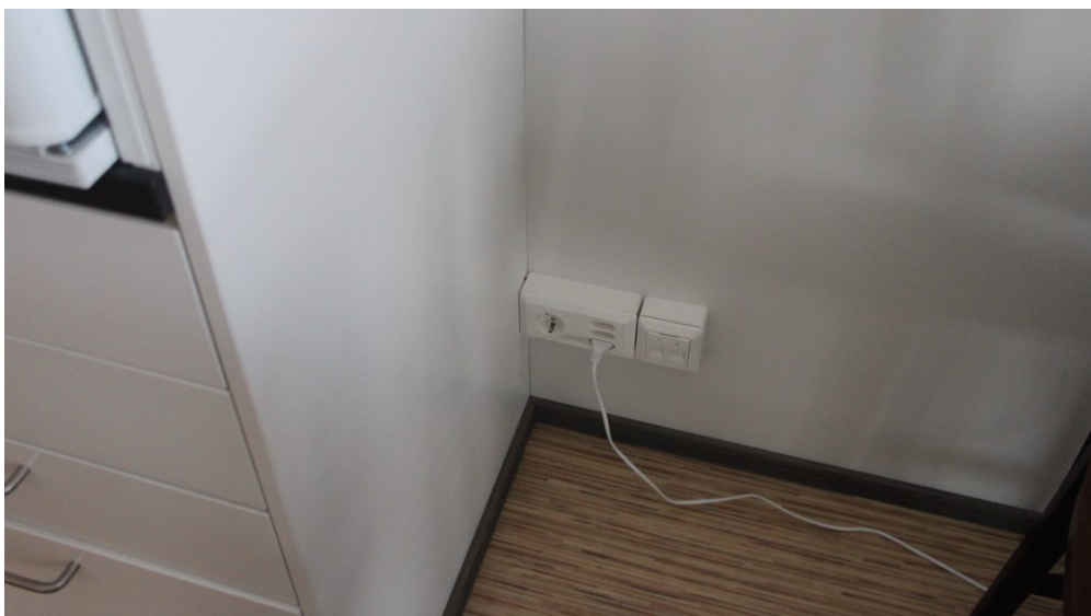
Kuva 44: Palveluasumisen kerrostalo, Tampere, 2020. Asunnon pistorasiat on sijoitettu aivan kiinteän kalusteen nurkkaan ja lattianrajaan, joka rajoittaa niiden käyttöä paljon. (Kuva: Hautasuo, 2023)
