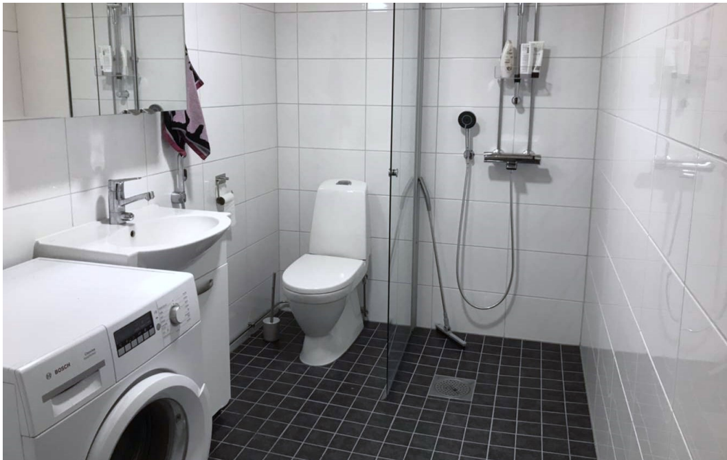
Kuva 45: Asuinkerrostalo, Tampere 2021. Pyörähdysympyrän tilan puutteen lisäksi tämän vessan ainoat pistorasiat sijaitsevat pesukoneen yläpuolella parin metrin korkeudessa. Niin korkealla ja vaikeassa paikassa sijaitsevaan pistorasiaan on kenen tahansa vaikea yltää. (Kuva: Hautasuo, 2023)
