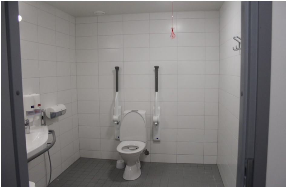
Kuva 46: Palveluasumisen kerrostalo, Tampere, 2020. LE-wc:n hätänarun sitominen ylös on turvallisuusriski. Wc-tilan naulakot sijaitsivat todella korkealla, eikä niihin pyörätuolia käyttävä henkilö yltäisi. (Kuva: Hautasuo, 2023)
