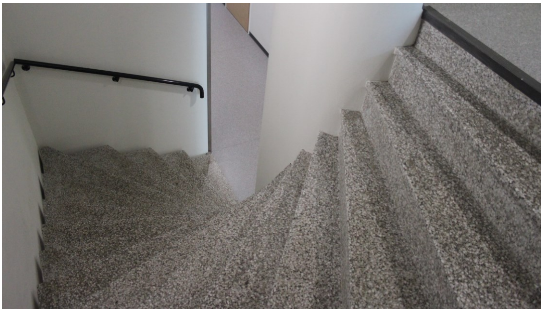
Kuva 38: Opiskelija-asuinkerrostalo, Tampere, 2019. Kierreportaissa kulku on yleisesti vaikeaa, sillä askelman etenemä on riittävä vain toisessa reunassa. Käsijohteen puuttuminen sisäreunasta myös vaikeuttaa portaissa kulkua. (Kuva: Hautasuo, 2023)
