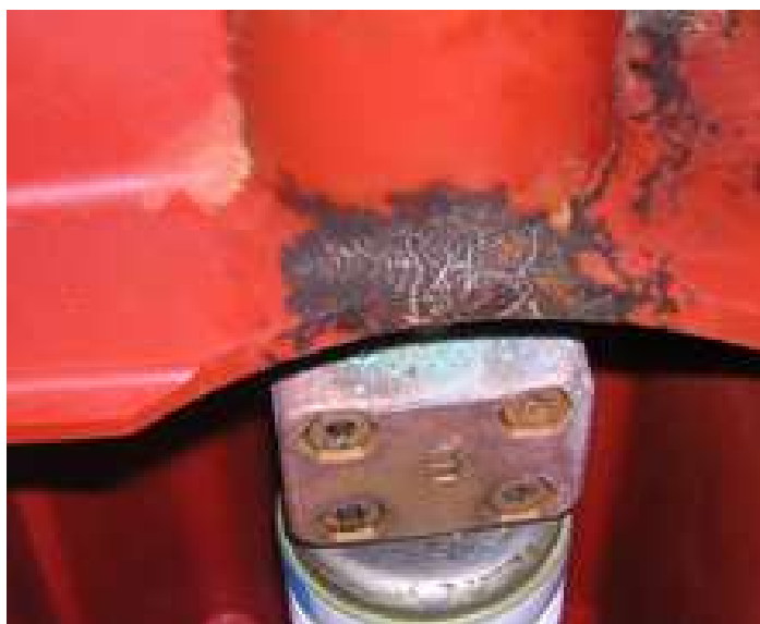
Kuva 2. Osittaispurkauksesta syntynyt eroosiojälki
