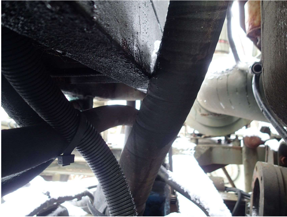
KUVA 11. Vuotava LHS-hydrauliikkasäiliön paluuputki.
