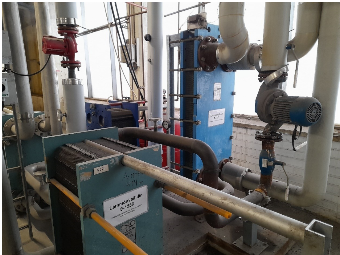
Kuva 23. Ilmapuhaltajien ja höyryn lämmönsiirrin.
