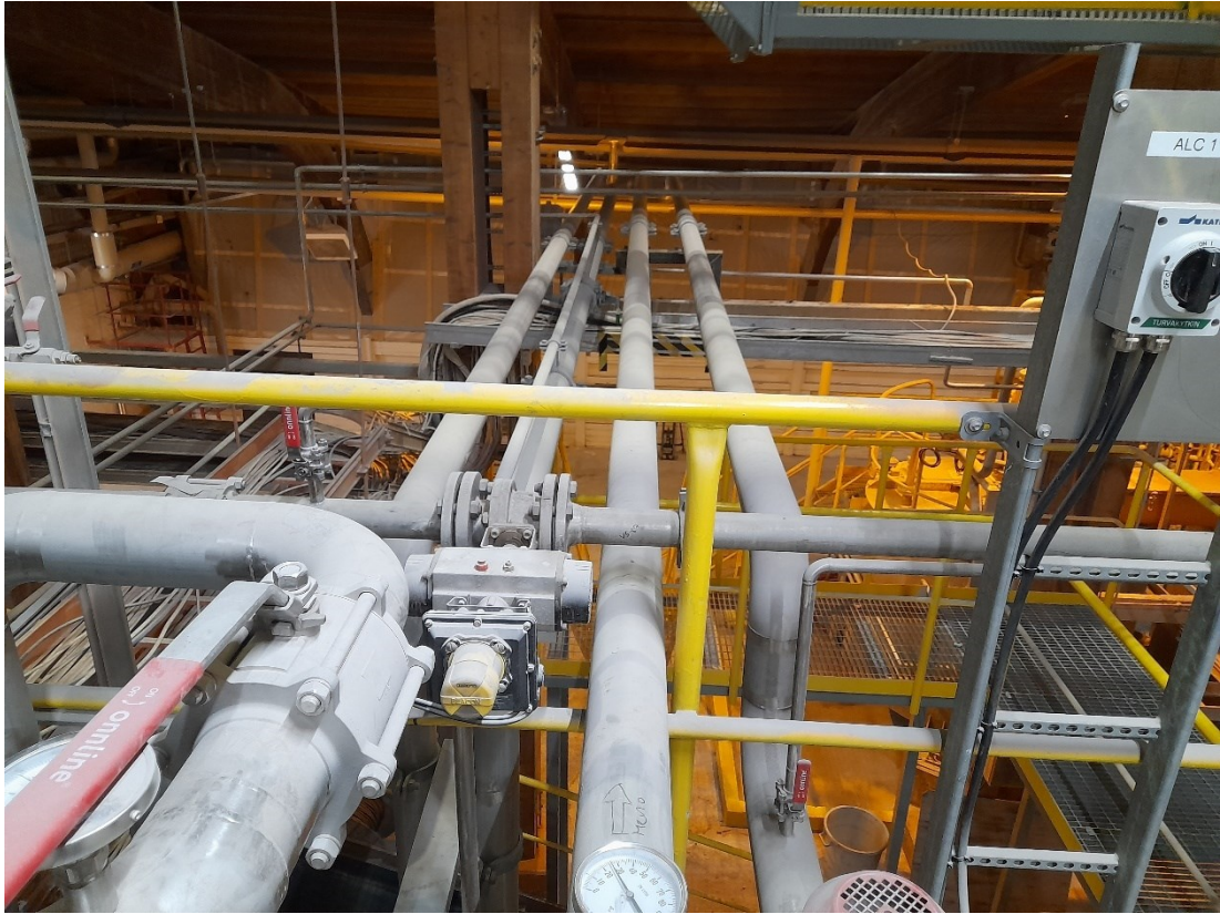
Kuva 14. Raakaveden ja lämmitysveden putkilinjat
