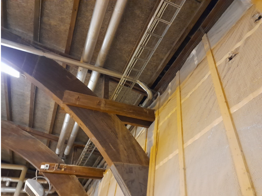
Kuva 17. Ehdotettu paikka toiselle uudelle ilmapuhaltajalle.
