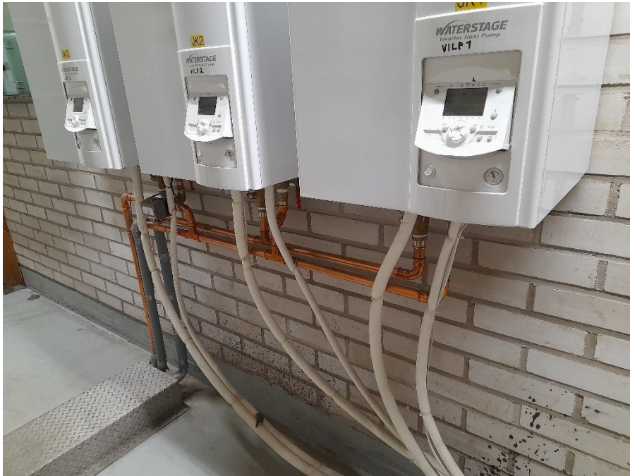
Kuva 29. Kaikki ilma-vesilämpöpumpujen sisäyksiköt ja putkistot.
