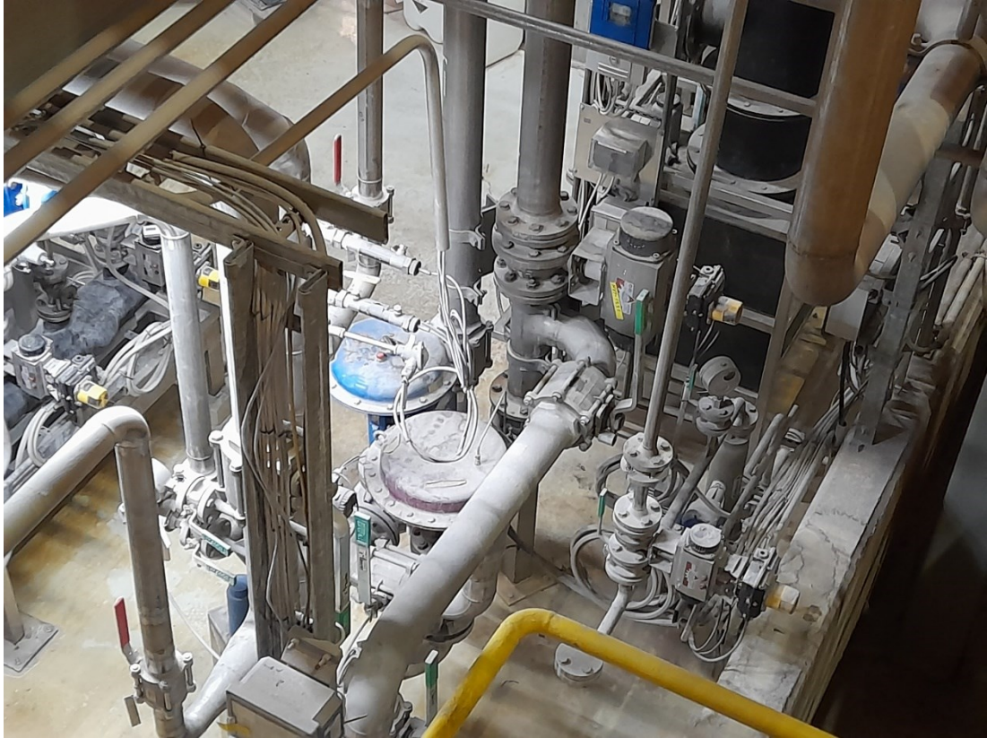
Kuva 11. Raakaveden putkisto ylhäältä
