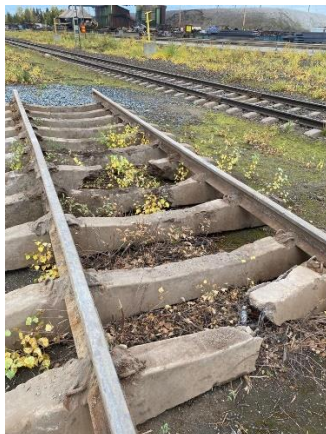
Kuva 21. Huonokuntoisia betonipölkkyjä, SSAB Raahe
