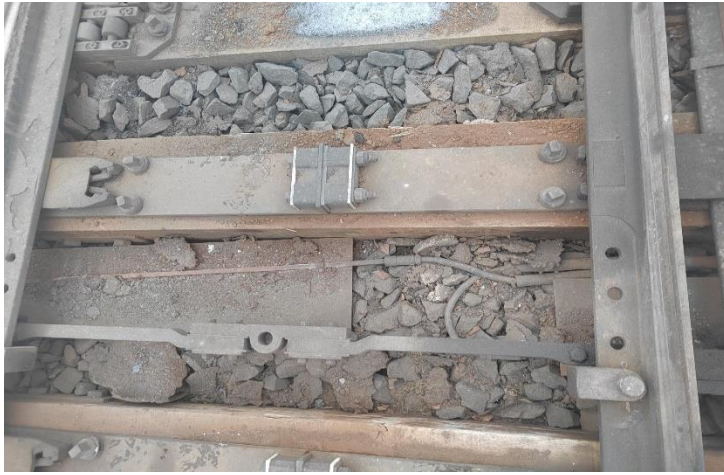
Kuva 25. Lämmitysvastukset radassa, SSAB Raahe
