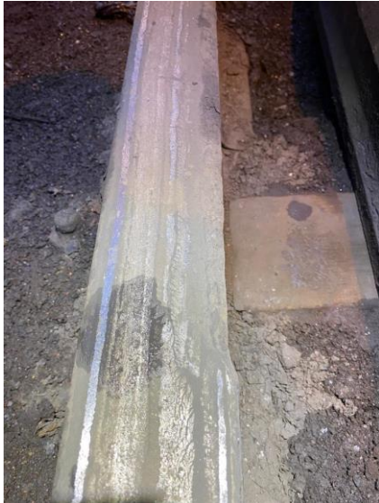
Kuva 20. Kulunut tukikisko vaihteessa, SSAB Raahe
